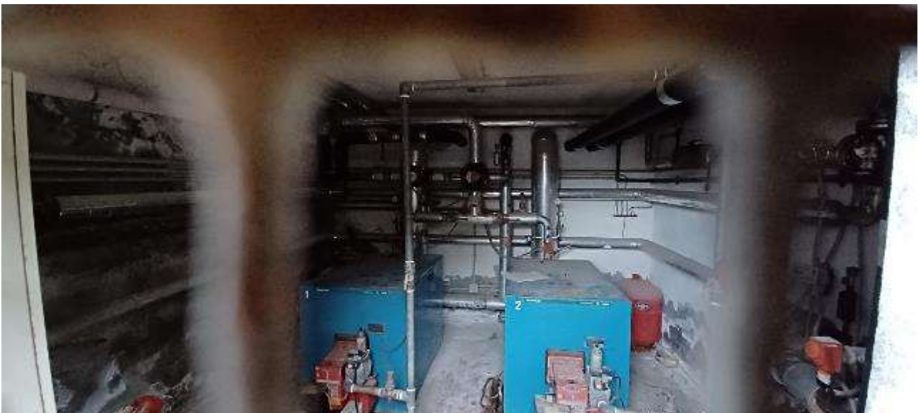
Foto n. 12. Seminterrato. Centrale Termica
