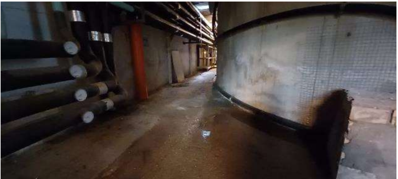
Foto n. 11. Seminterrato. Impianti tecnologici e vasca piscina
