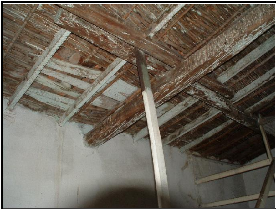
FOTO 23 – Particolare della struttura della copertura sopra il vano scala ( in evidente stato di degrado)
