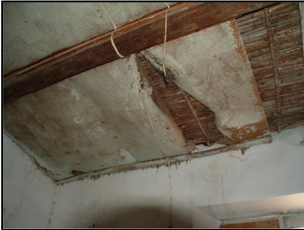
FOTO 22 – particolare della copertura vista dalla soffitta ( in evidente stato di degrado)
