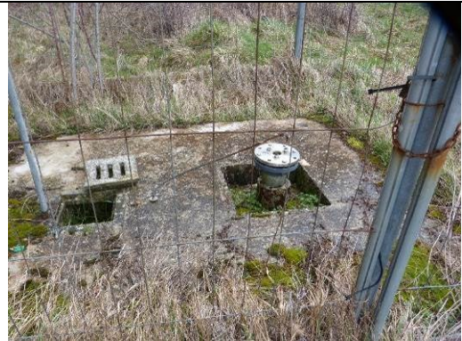
Recinzione in corrispondenza del pozzo di estrazione acque termali
