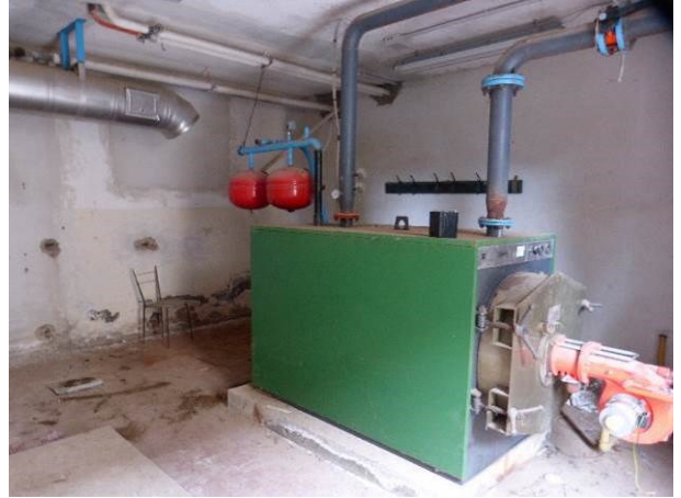
Vista della centrale termica nell'edificio "A"
