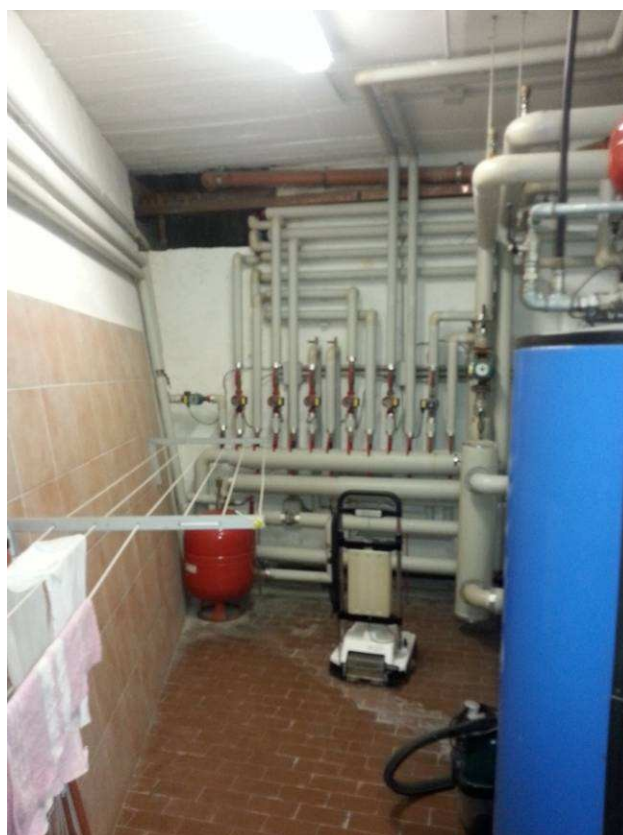
Piano interrato: Vista interna centrale termica (mapp. 305 sub. 6)
