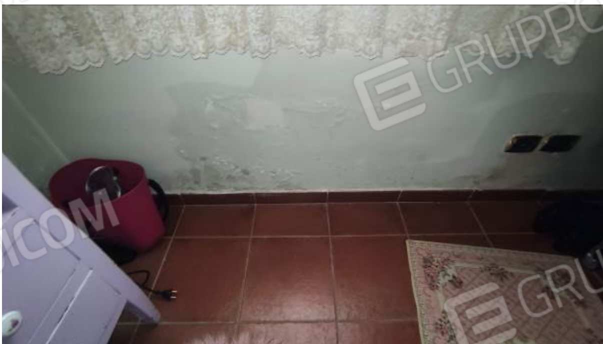
Foto n° 49: Piano Seminterrato – ripostiglio – particolare umidità di risalita
