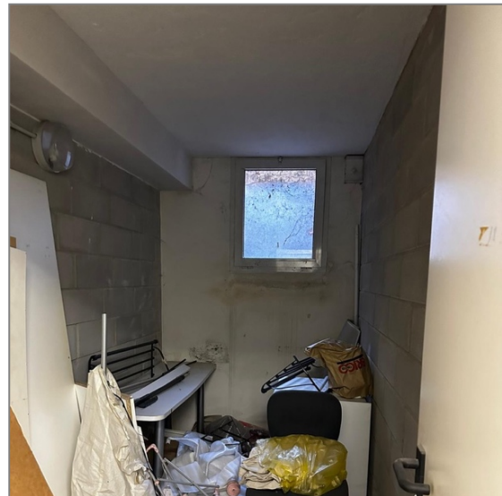
Cantinola al p. interrato
