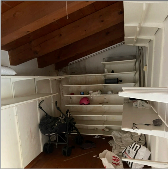
Ripostiglio non autorizzato al p. primo
