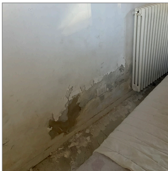
Pareti ammalorate al piano terra
