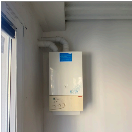
Caldaia murale al primo livello
