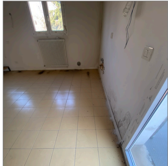
Ammaloramenti al primo livello
