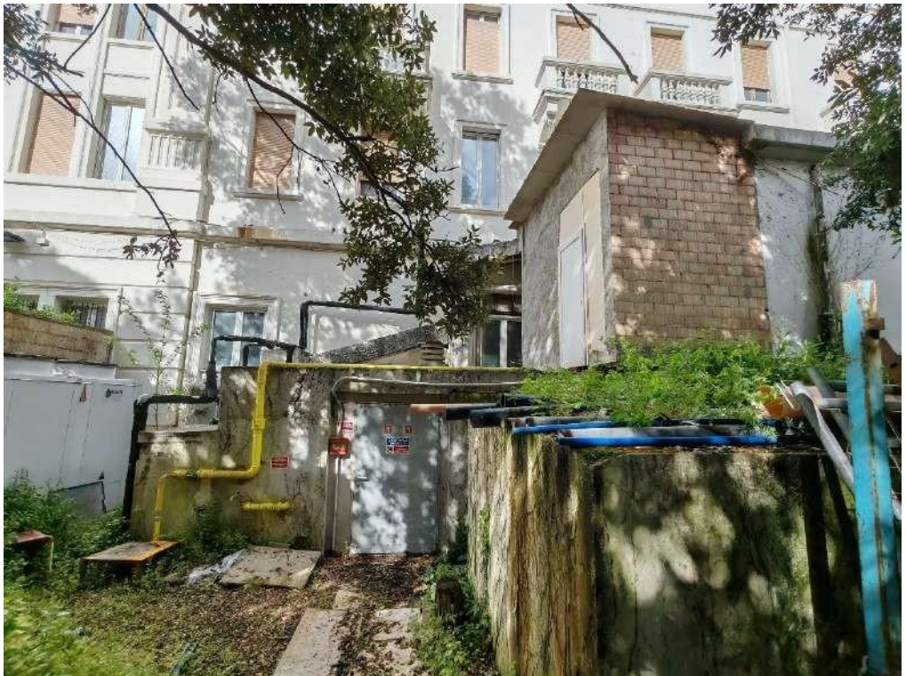
CENTRALE TERMICA E IMPIANTI
