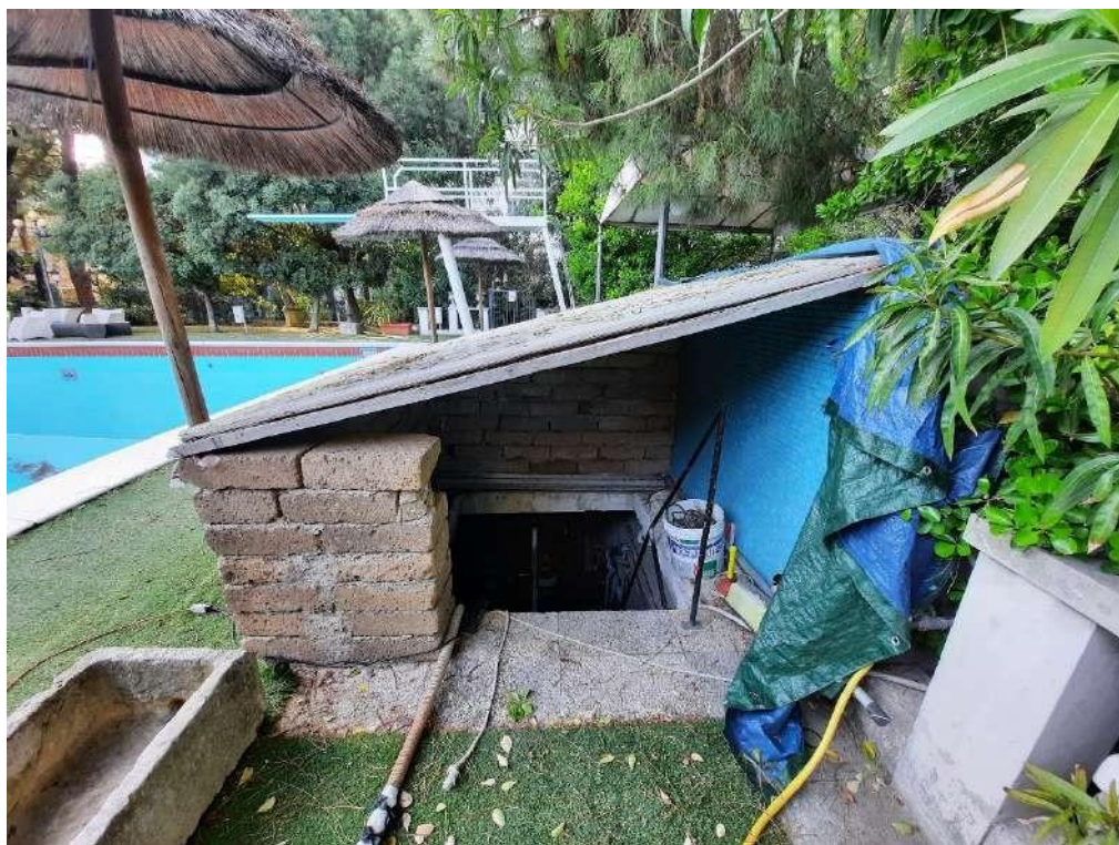
ACCESSO AL LOCALE IMPIANTI (ricadente sul sub 90 corte BCNC i sub 61 e 62)
