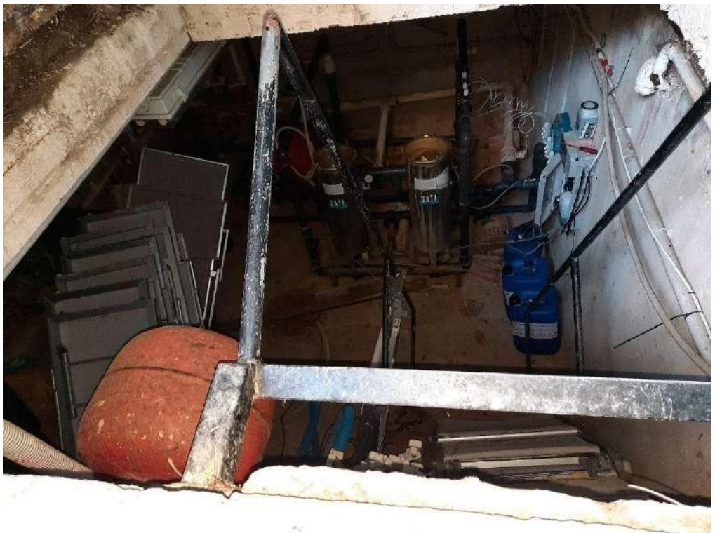
LOCALE IMPIANTI (ricadente sul sub 90 corte BCNC i sub 61 e 62)
