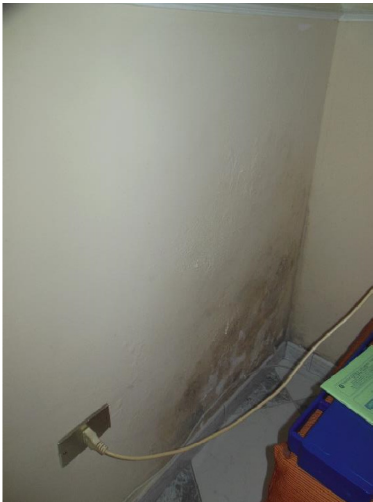
Foto 31 - Vista interna camera n. 3: dettaglio attacco parete/pavimento lato est
