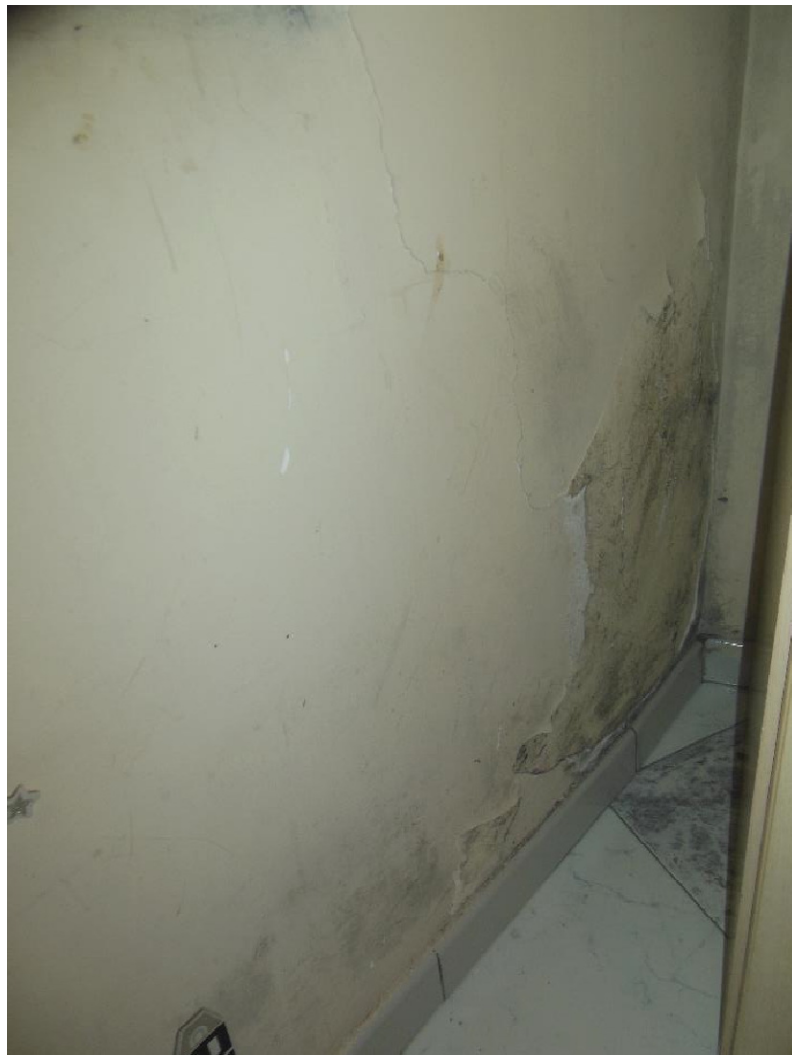
Foto 24 - Vista interna camera n. 1: dettaglio attacco parete/pavimento lato ovest
