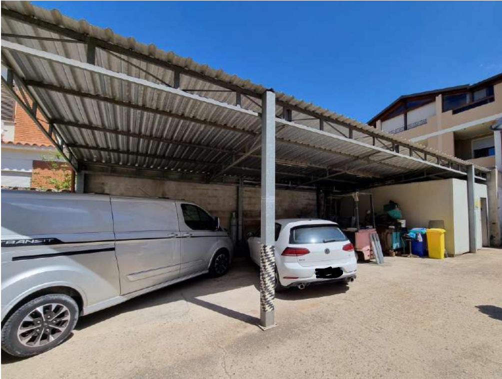
Foto 37. Il loggiato/gazebo e sulla destra la partizione non autorizzata.
