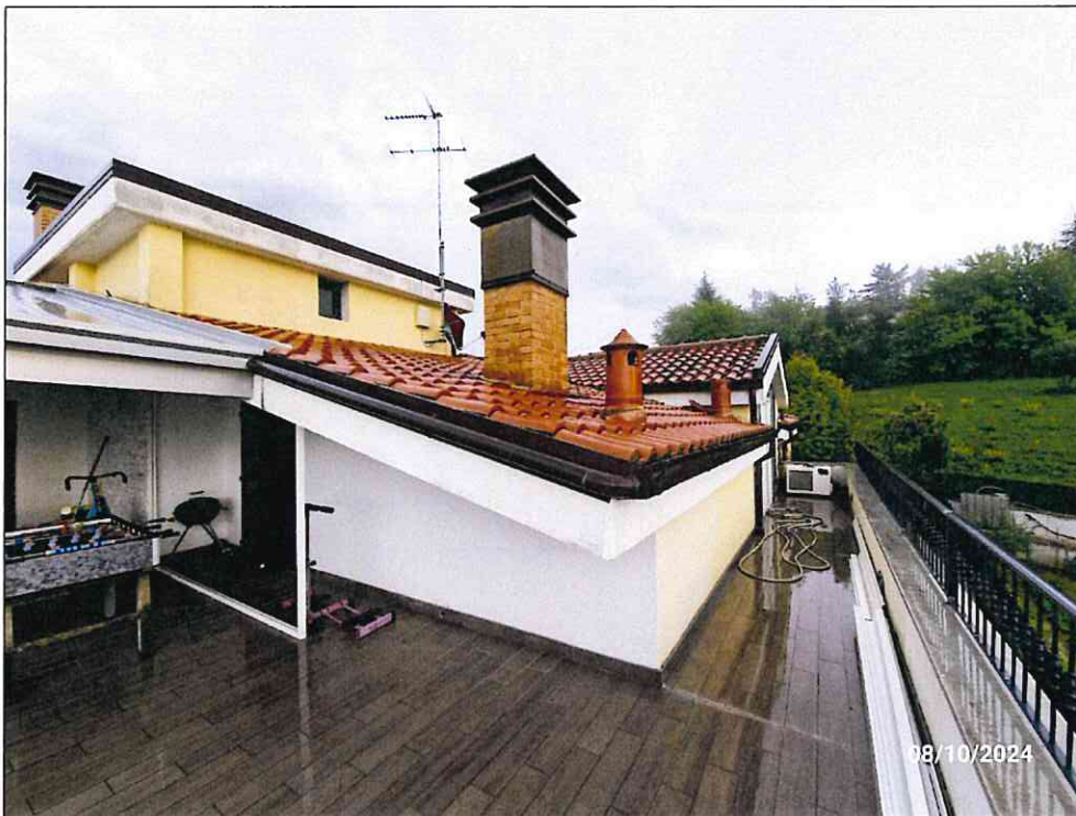
Foto 41: terrazzo 1 e struttura metallica (non autorizzata)
