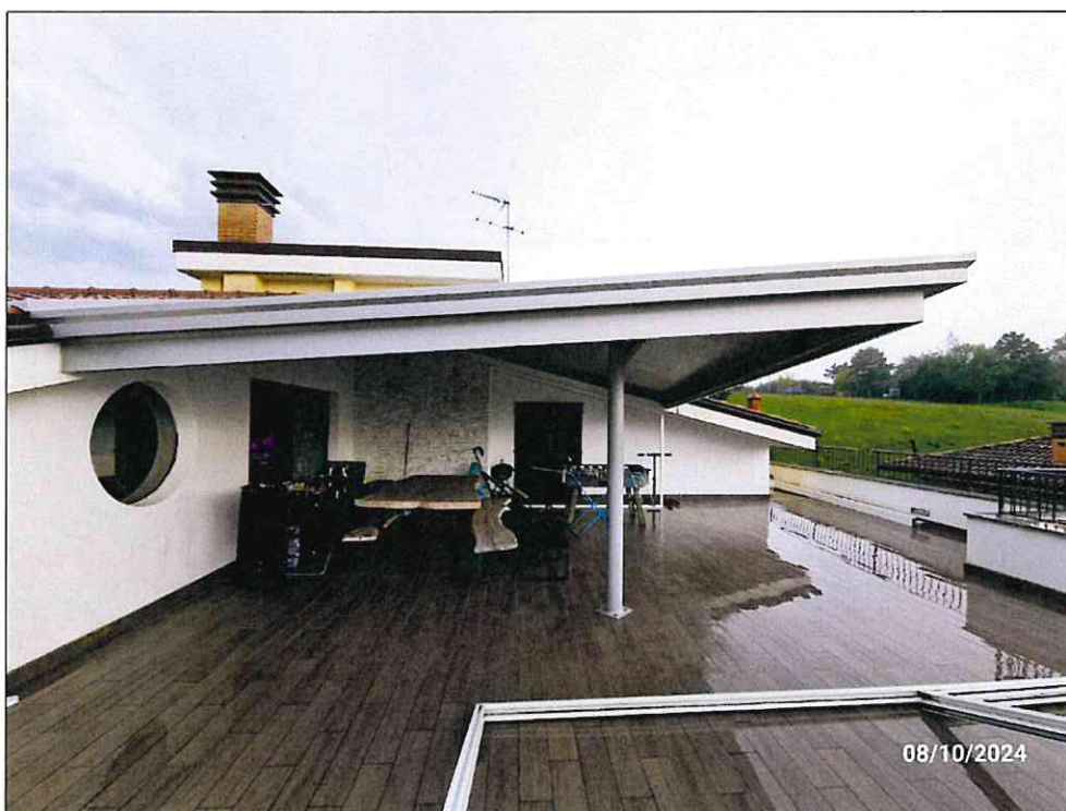
Foto 37: terrazzo 1 e struttura metallica (non autorizzata)
