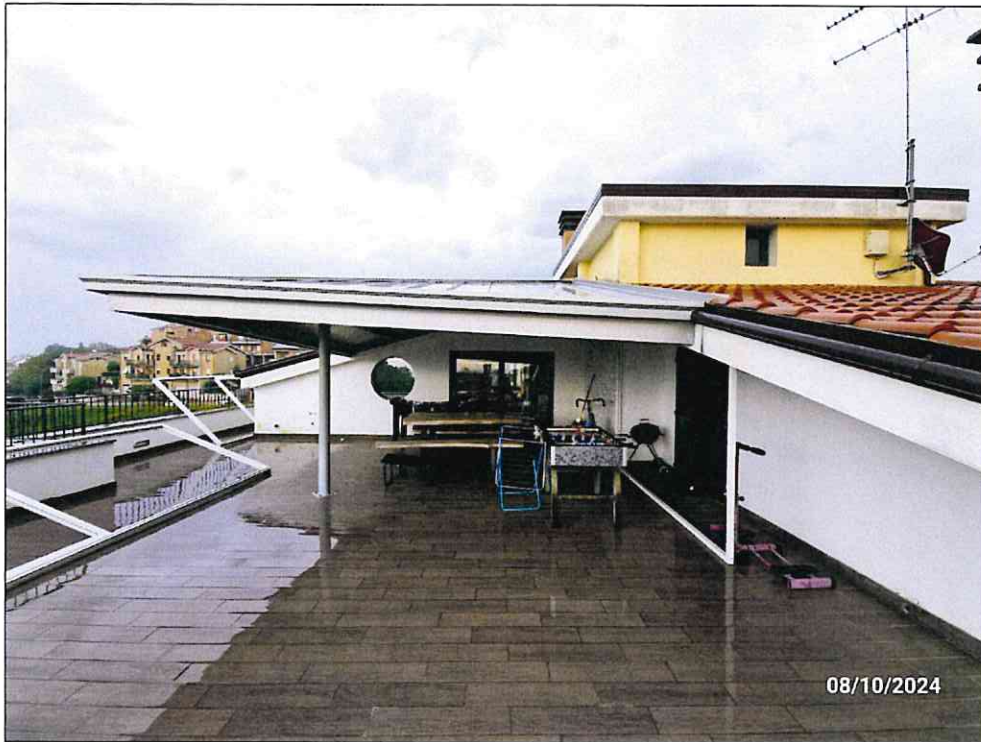
Foto 38: terrazzo 1 e struttura metallica (non autorizzata)
