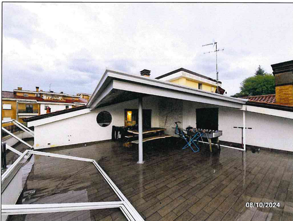
Foto 39: terrazzo 1 e struttura metallica (non autorizzata)
