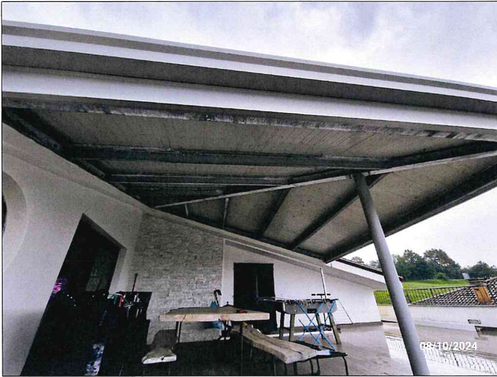
Foto 40: terrazzo 1 e struttura metallica (non autorizzata)
