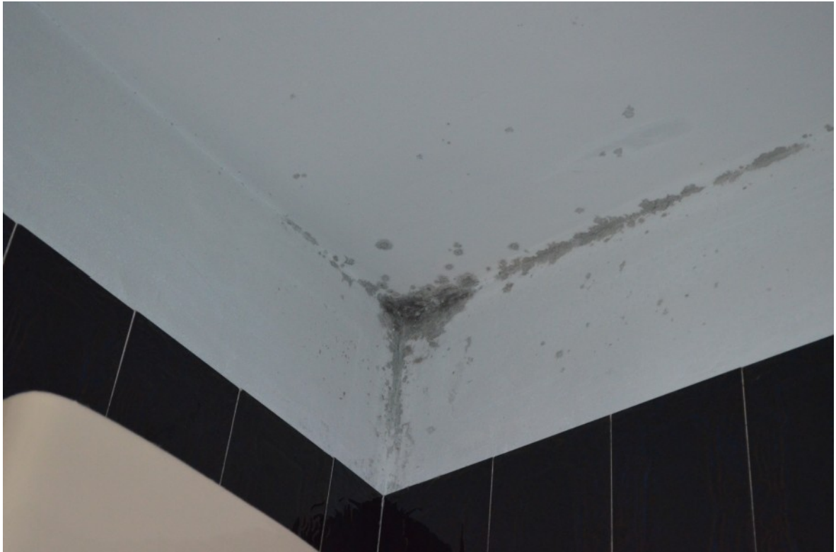
Fenomeno di condensa nel bagno padronale
