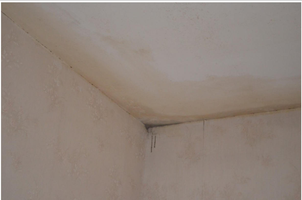
Fenomeno di condensa nella camera da letto
