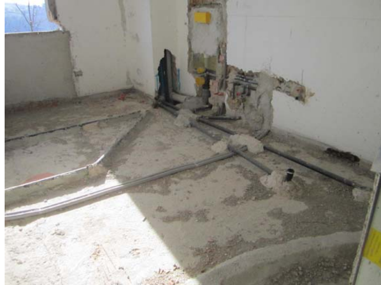
foto n.10 - PIANO TERRA impianti
