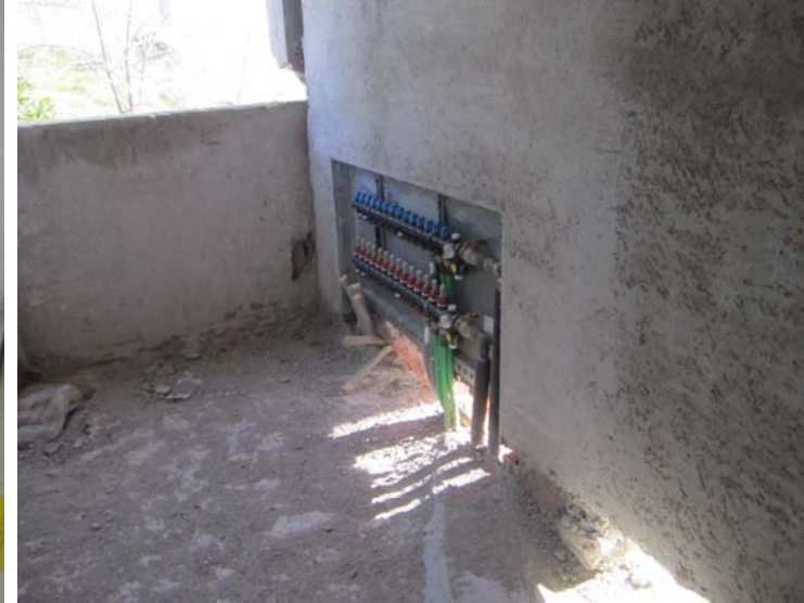
foto n.11 - PIANO TERRA impianti
