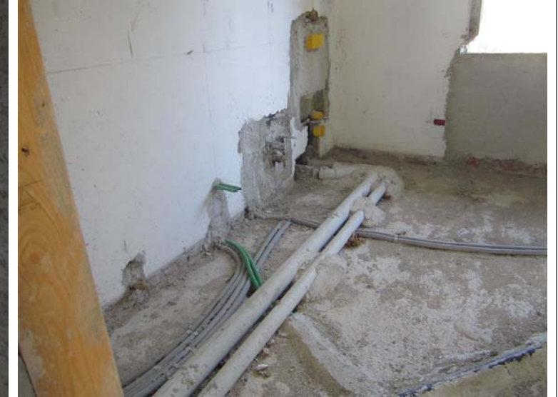
foto n.12 - PIANO TERRA impianti
