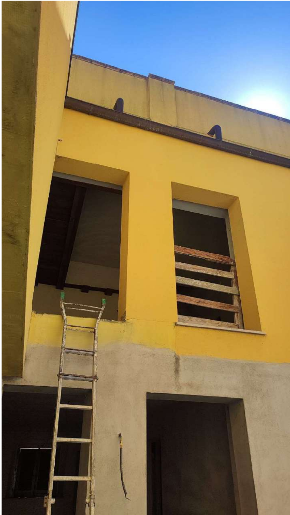
Ingresso esterno ancora da realizzare tramite passerella metallica
