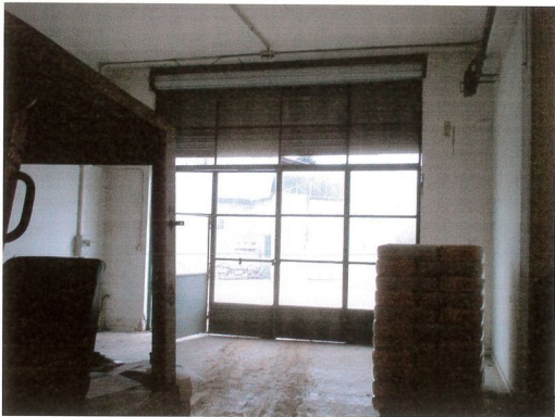
Interno locale "A"
