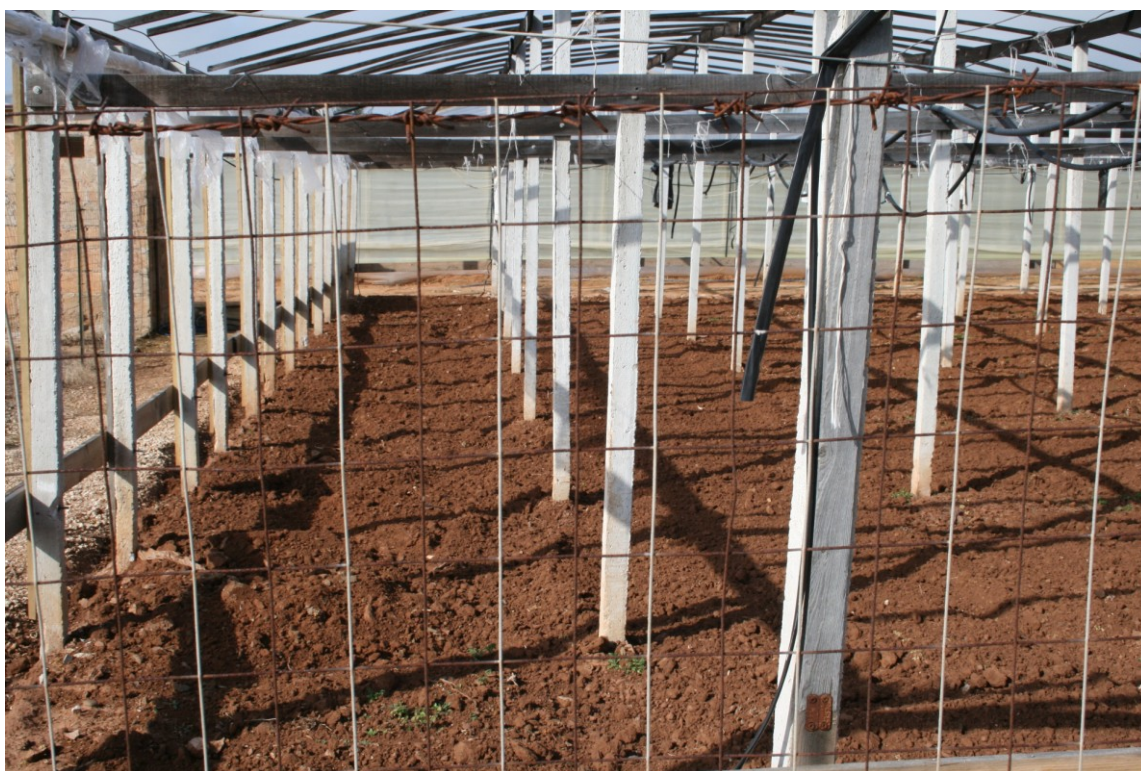
Foto n° 4 Particolare della struttura delle serre in pilastri in c.a. e soprastante struttura in legno.
