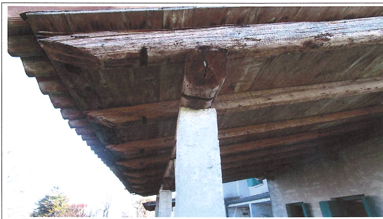
Pergolato da ripristinare rimuovendo la copertura.
