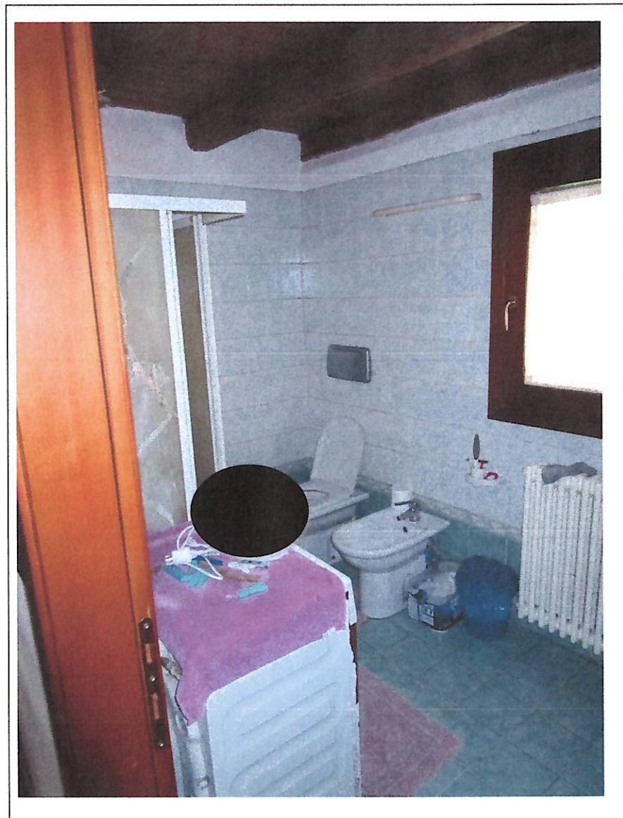
Bagno piano terra con pavimentazione da rialzare.
