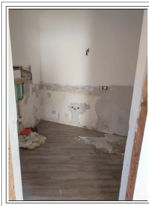
Foto N°13 - W.C. : interno privo di rivestimento parietale e sanitari
