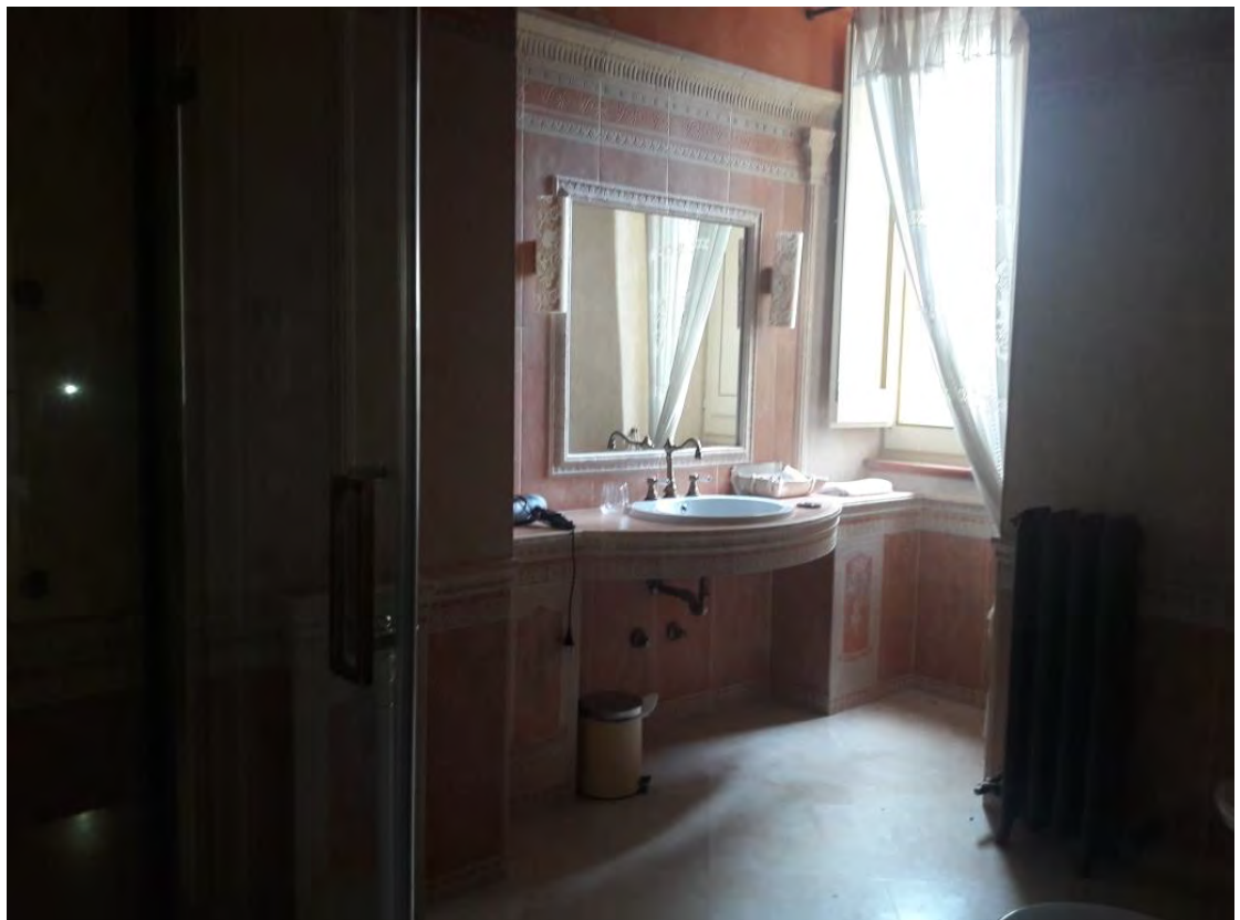
FOTO 42 (VILLA ADA: Bagno Piano Primo Sottostrada)
