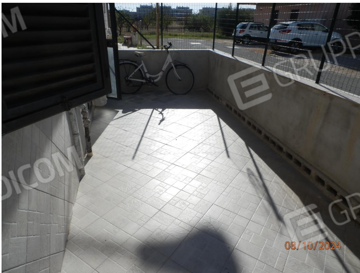
Foto 12 - recinzione e pavimentazione abusiva della corte comune
