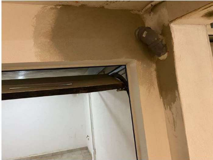
Foto n.30 .Via Parigi n.5E- Villasimius. Box auto. E' visibile la curva di collegamento con la colonna montante di scarico delle unità immobiliari sovrastanti.
