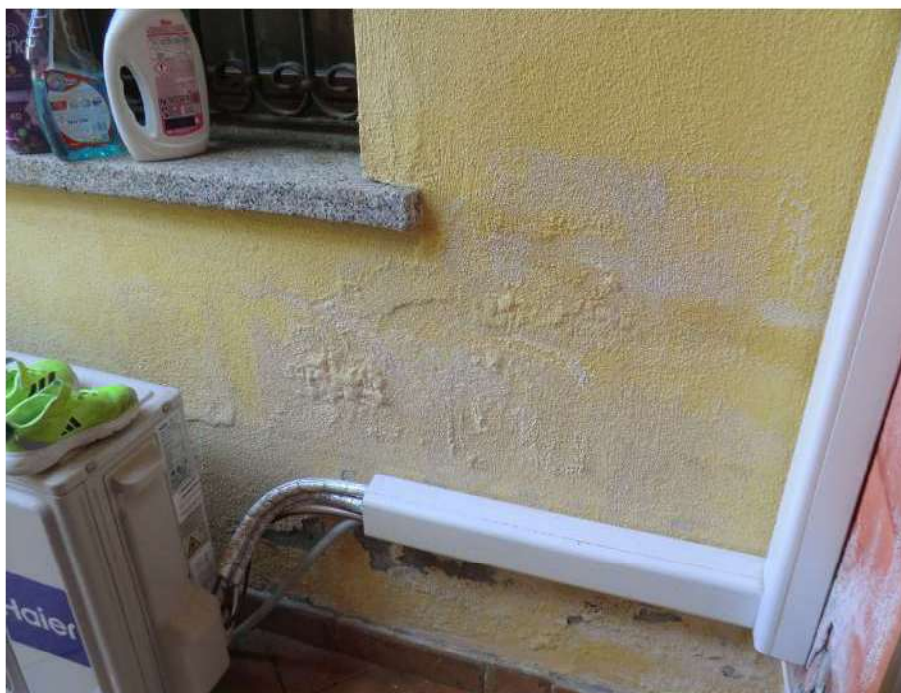
Foto n.21 .Via Parigi n.5F- Villasimius. Cortile lato prospetto principale. Parete di tamponatura del bagno principale.
