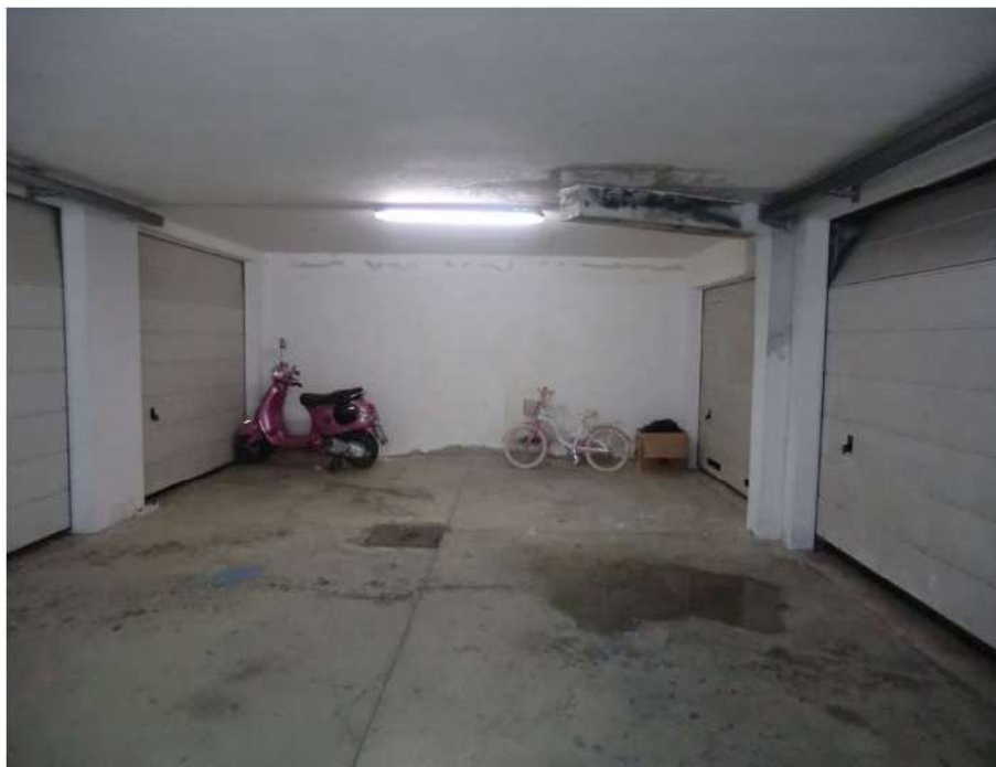
Foto n.26 .Via Parigi n.5E- Villasimius. Box auto. Sono visibili le copiose infiltrazioni provenienti dall'immobile sovrastante e le tracce di acqua sul pavimento.
