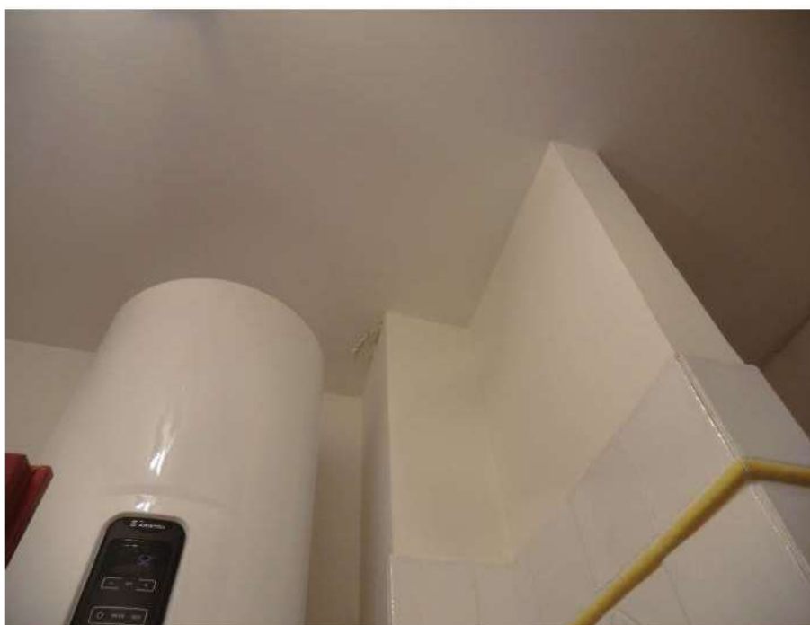
Foto n.12 . Via Parigi n.5F- Villasimius. Bagno principale. Tracce di infiltrazioni in corrispondenza di un finto pilastro sede della colonna montante degli scarichi delle acque nere.
