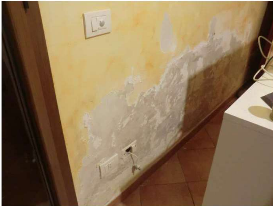
Foto n.9. Via Parigi n.5F- Villasimius. Camera matrimoniale. Tracce di infiltrazioni nella parete confinante con il bagno.
