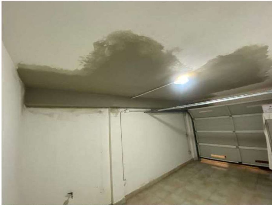
Foto n.28 .Via Parigi n.5E- Villasimius. Box auto. Ripristini eseguiti di recente. E' visibile la finta trave sede del tubo di scarico del nuovo bagno.
