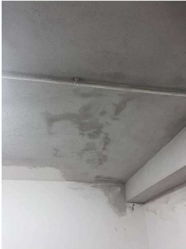
Foto n.29 .Via Parigi n.5E- Villasimius. Box auto. Sono visibili le infiltrazioni dopo i recenti ripristini e la finta trave sede della tubazione di scarico del nuovo bagno.
