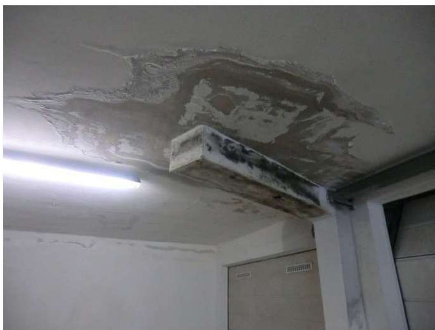
Foto n.27 .Via Parigi n.5E- Villasimius. Box auto. Sono visibili le copiose infiltrazioni.
