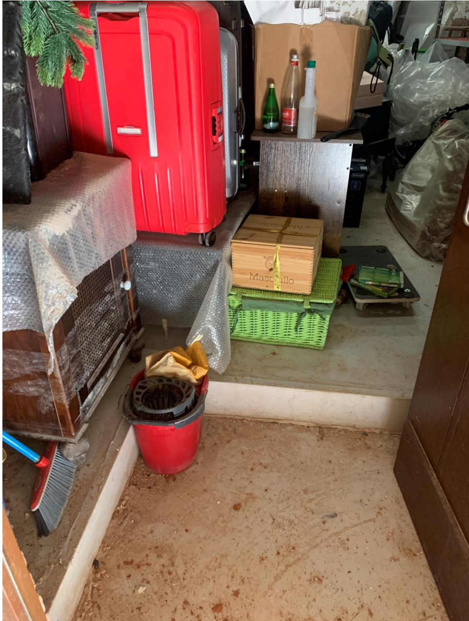
Foto n°15: particolare pavimento magazzino.
