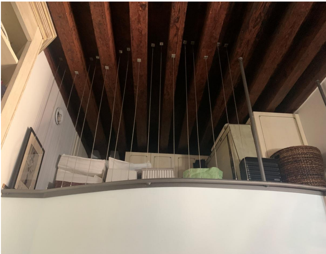
Foto n°10: soppalco (non legittimo).
