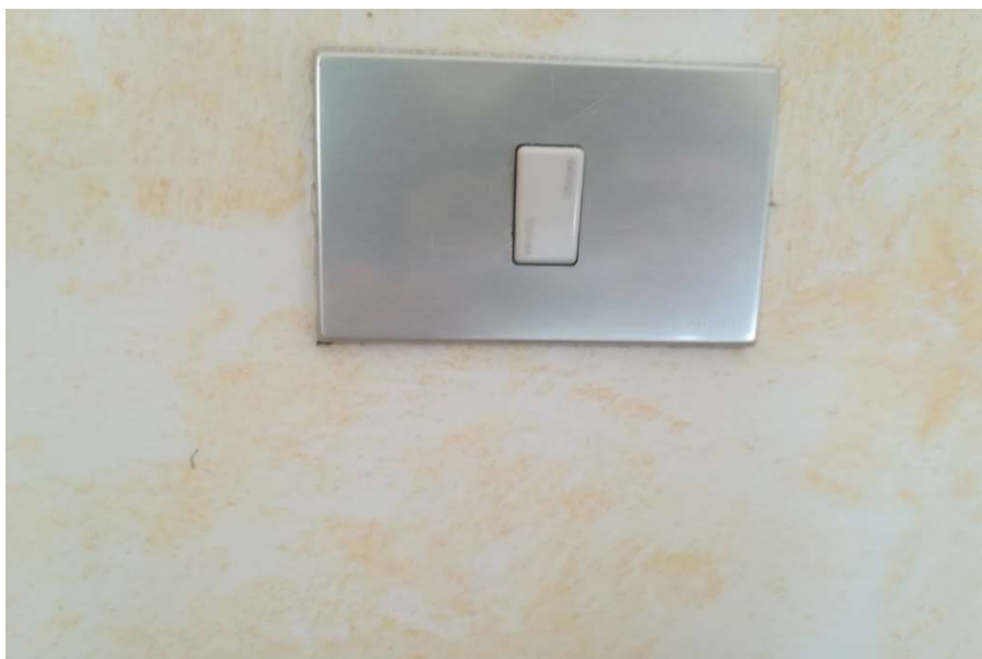
44 | Interno Piano primo Particolare placche impianto elettrico
