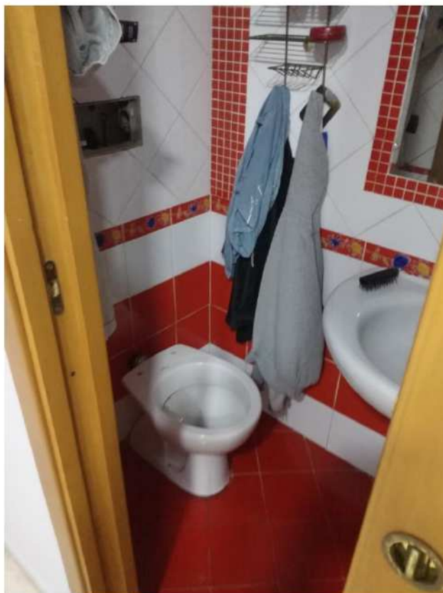
Foto n. 48 – Camera n.2 – Bagno n. 2
