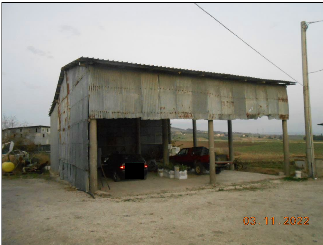
FOTO N. 43 Vista della capanna in lamiera, per il ricovero di mezzi, fg. 3 p.lla 435/8.
