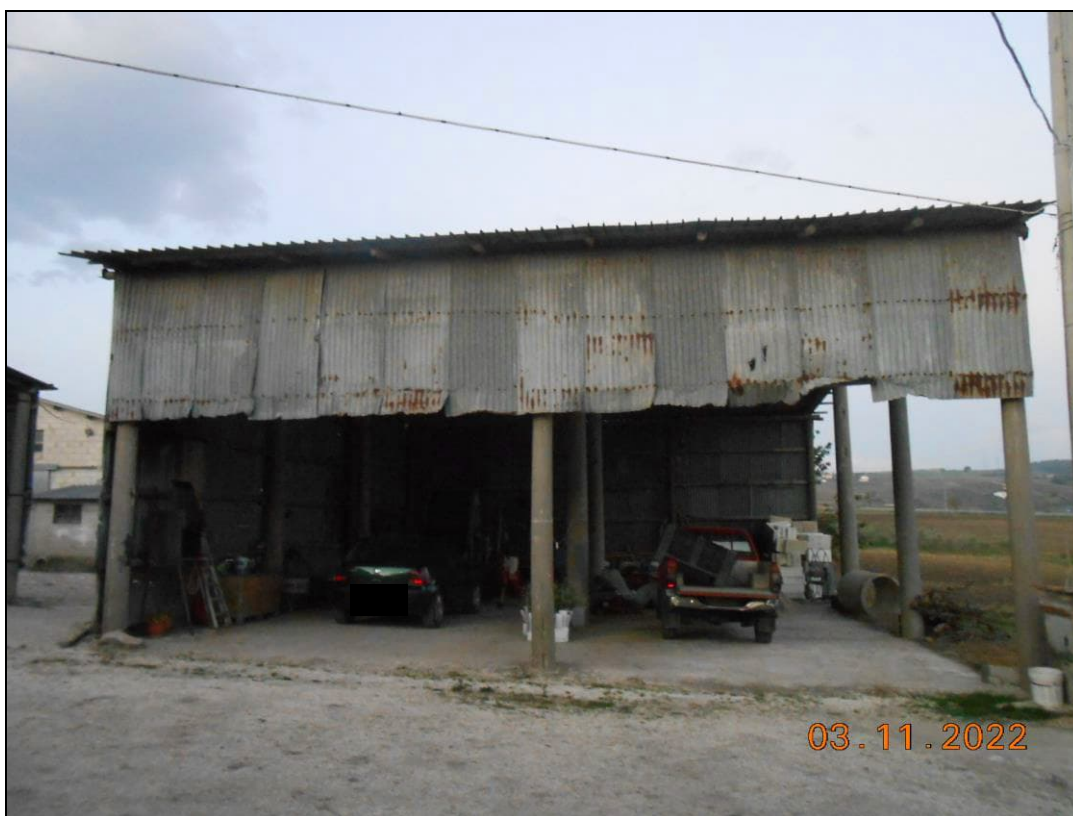
FOTO N. 44 Vista della capanna in lamiera, per il ricovero di mezzi, fg. 3 p.lla 435/8.
