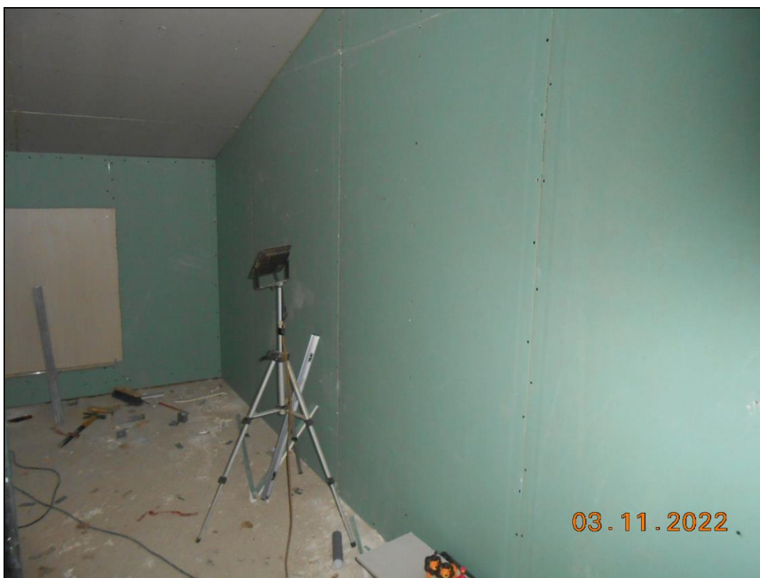
FOTO N. 32 Vista del piano sottotetto dell'immobile pignorato, variato in mansarda. Si nota la parte in fase di completamento.
