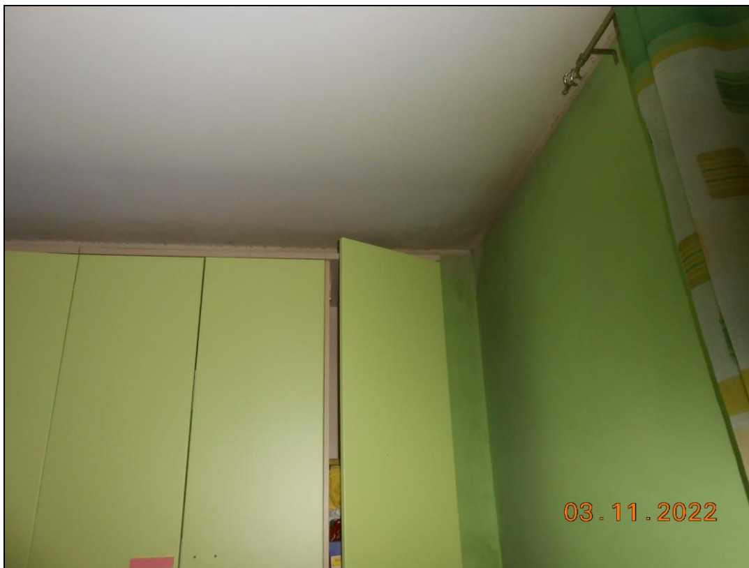
FOTO N. 17 Vista interna a piano terra dell'immobile pignorato. Si notano le macchie di condensa sulle pareti e soffitto.
