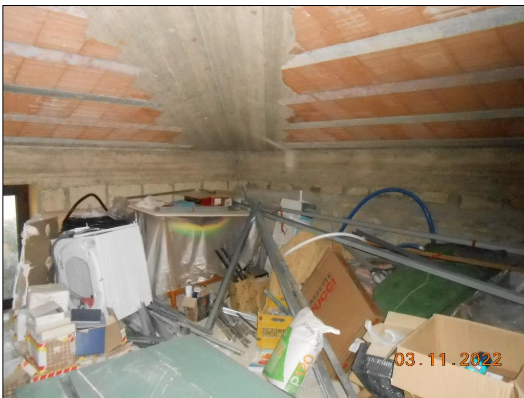
FOTO N. 34 Vista del piano sottotetto dell'immobile pignorato, variato in mansarda. Si nota la parte allo stato rustico.
