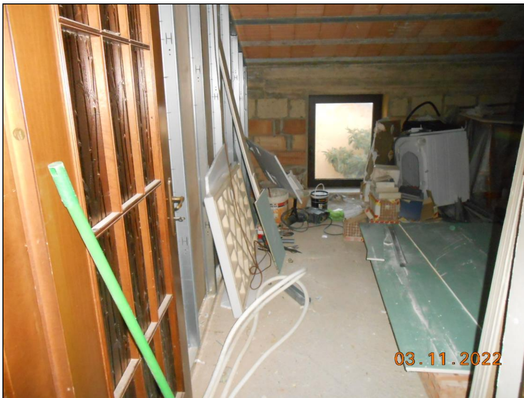
FOTO N. 33 Vista del piano sottotetto dell'immobile pignorato, variato in mansarda. Si nota la parte in fase di completamento.
