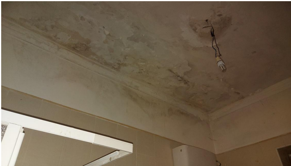
Tracce infiltrazioni soffitto bagno wc 1
