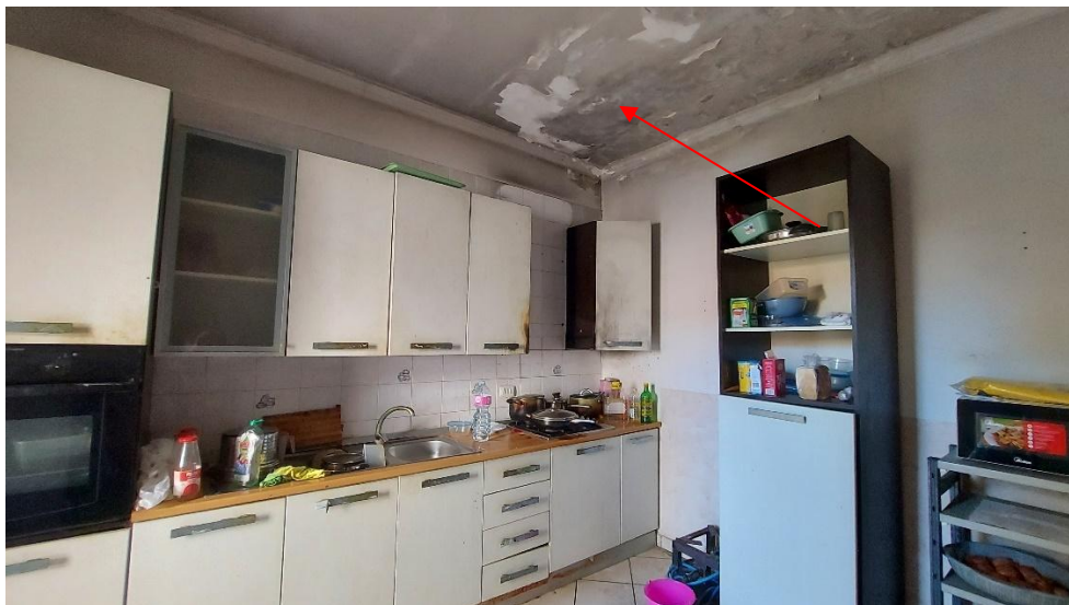
Tracce incendio soffitto cucina
