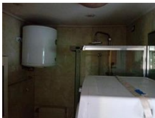
Accessorio Deposito servizio igienico non esistente nelle pratiche edilizie
