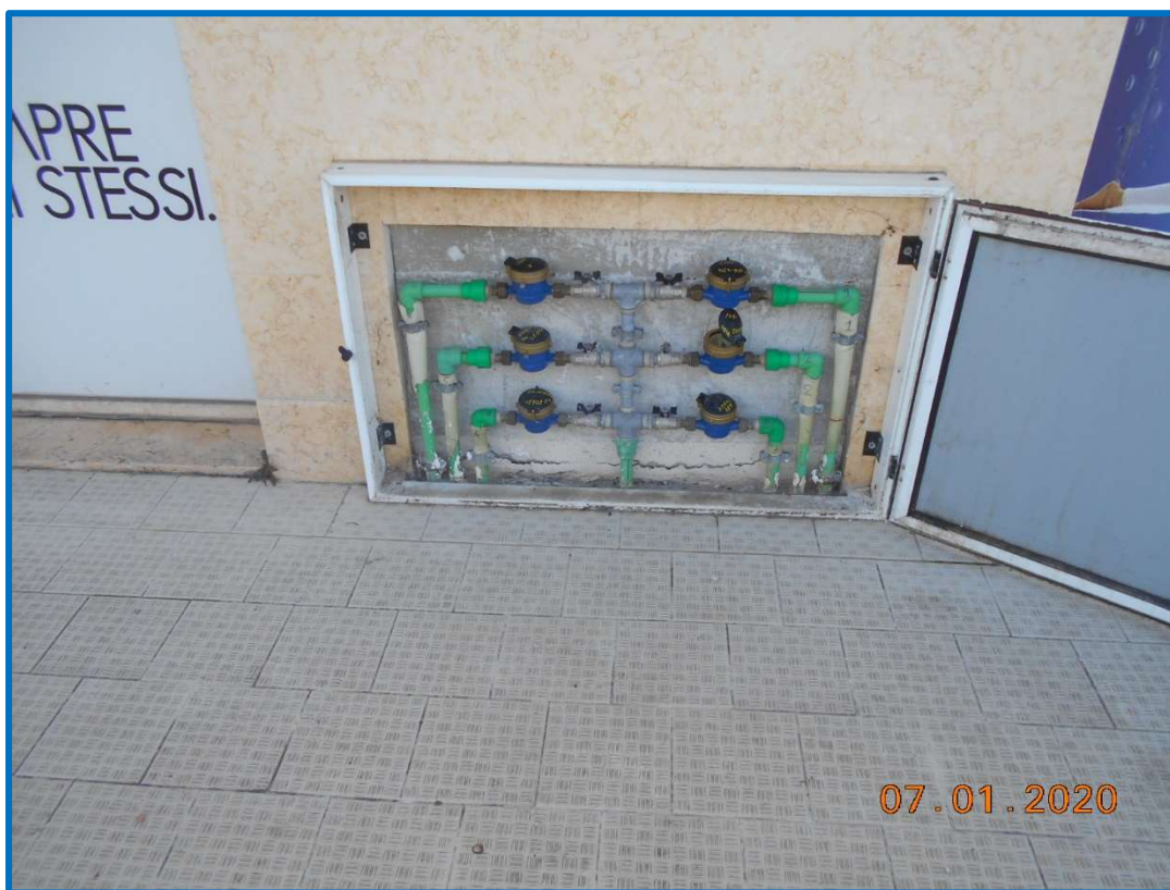
FOTO N.22: divisionali acqua in vano esterno all'immobile in sub 18 – lotto n.4
