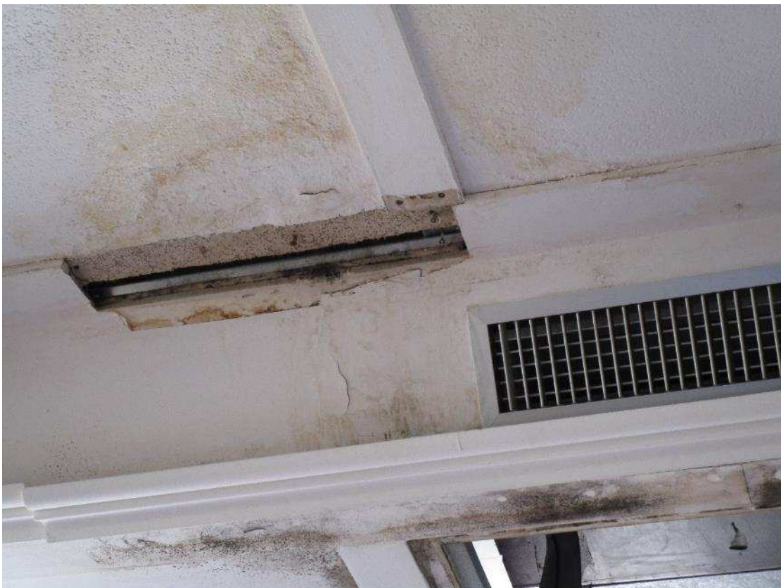
PARTICOLARE DEGRADO INTERNO
