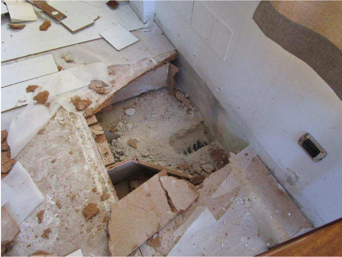
PARTICOLARE INTERNO (DEMOLIZIONE PAVIMENTO PER VERIFICA PERDITA TUBAZIONI)
