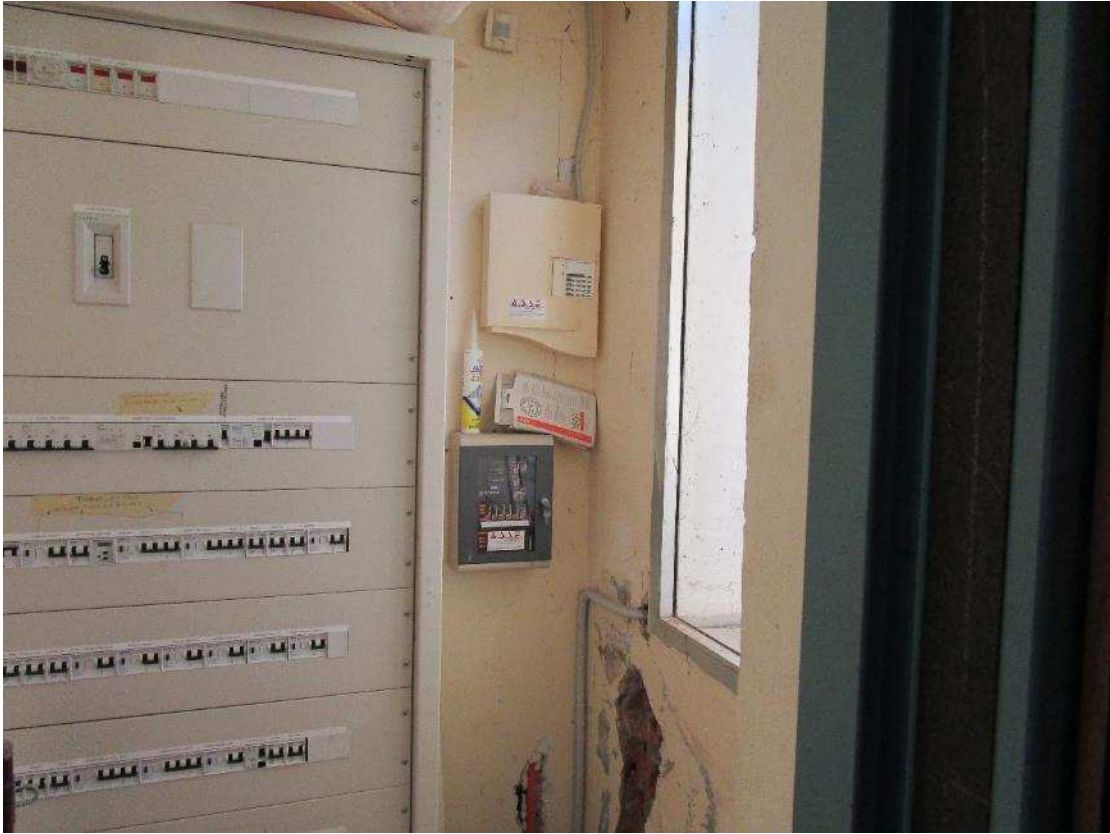
PARTICOLARE QUADRO ELETTRICO
