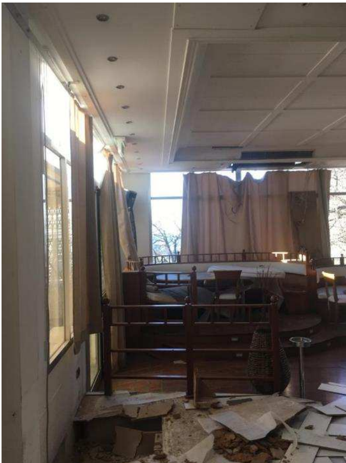
PARTICOLARE INTERNO (DEMOLIZIONE PAVIMENTO PER VERIFICA PERDITA TUBAZIONI)
