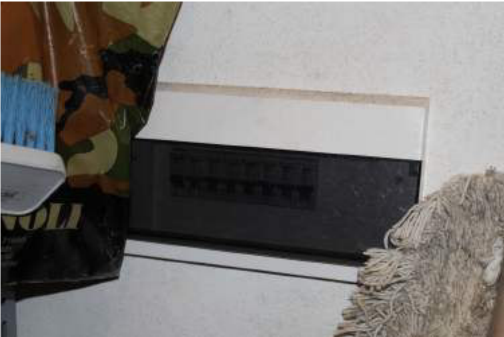
Foto n° 45 – Quadro elettrico, posto nel ripostiglio
