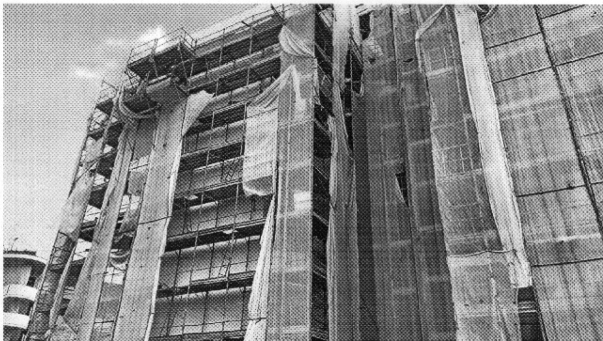
Foto dell'edificio effettuata durante le fasi di sopralluogo coperti dai ponteggi per i lavori in corso
