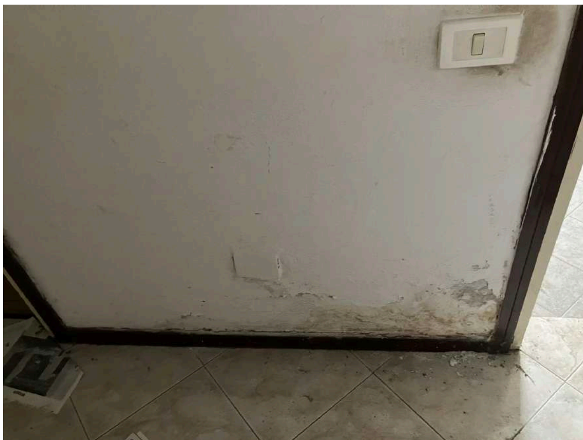
Foto n. 22 | Degrado da umidità nel disimpegno della zona notte.
