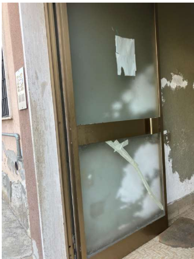
Foto n. 8 | Porta d'ingresso al condominio con rotture e degrado dell'intonaco all'ingresso.
