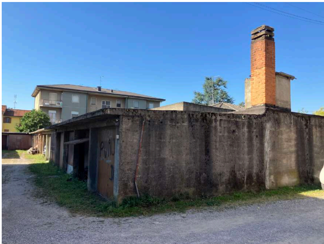
Foto n. 27 | Vista generale del fabbricato destinato ai box in evidente stato di degrado.
