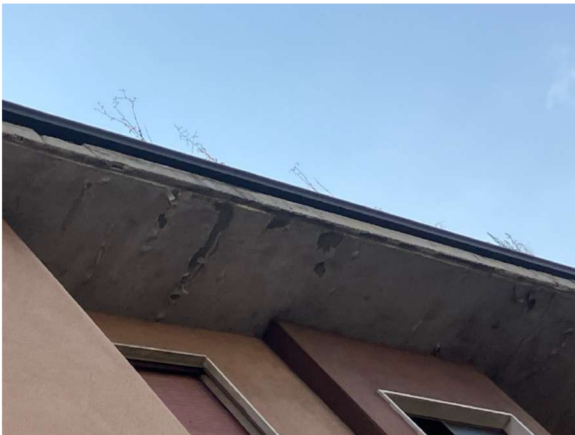
Foto n. 14 | Degrado degli intonaci in corrispondenza della gronda.
