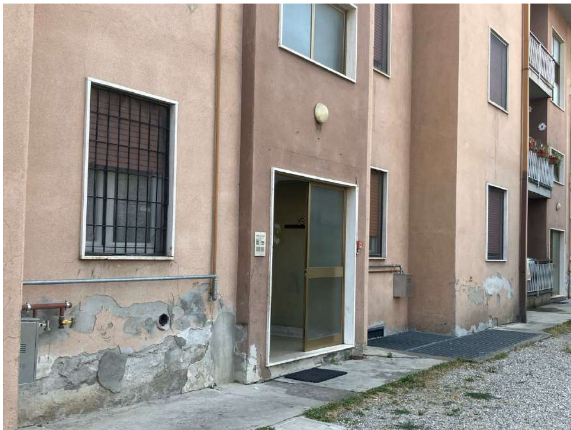
Foto n. 6 | Vista dell'ingresso condominiale con evidente degrado dell'intonaco (umidità di risalita).
