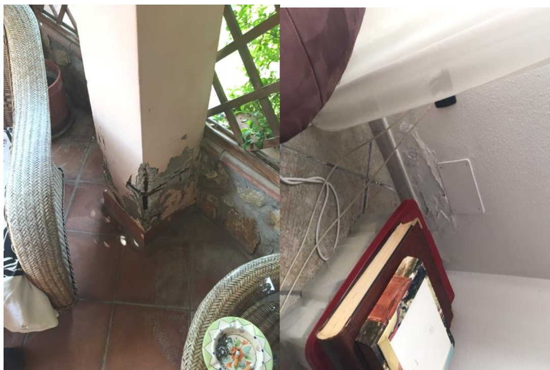
Figura 9: Particolari intonaco esterno e interno piano terra ammalorato
