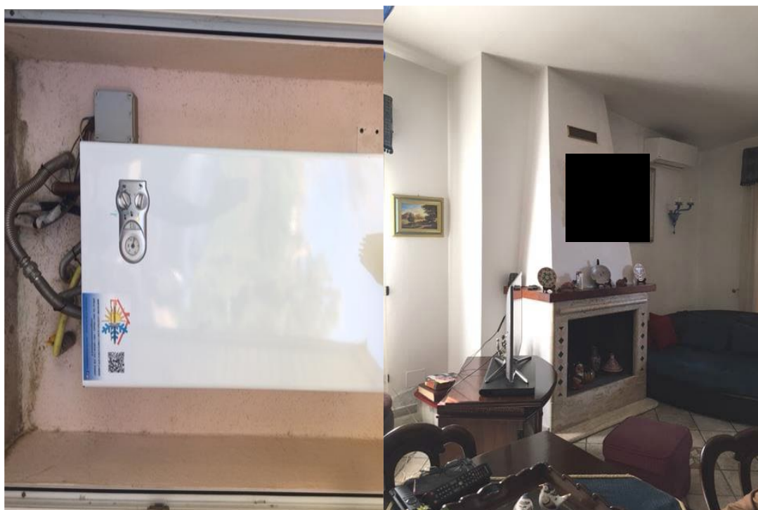
Figura 8: Particolari Caldaia posta adiacente Ingresso principale – Ambiente Soggiorno con caminetto
