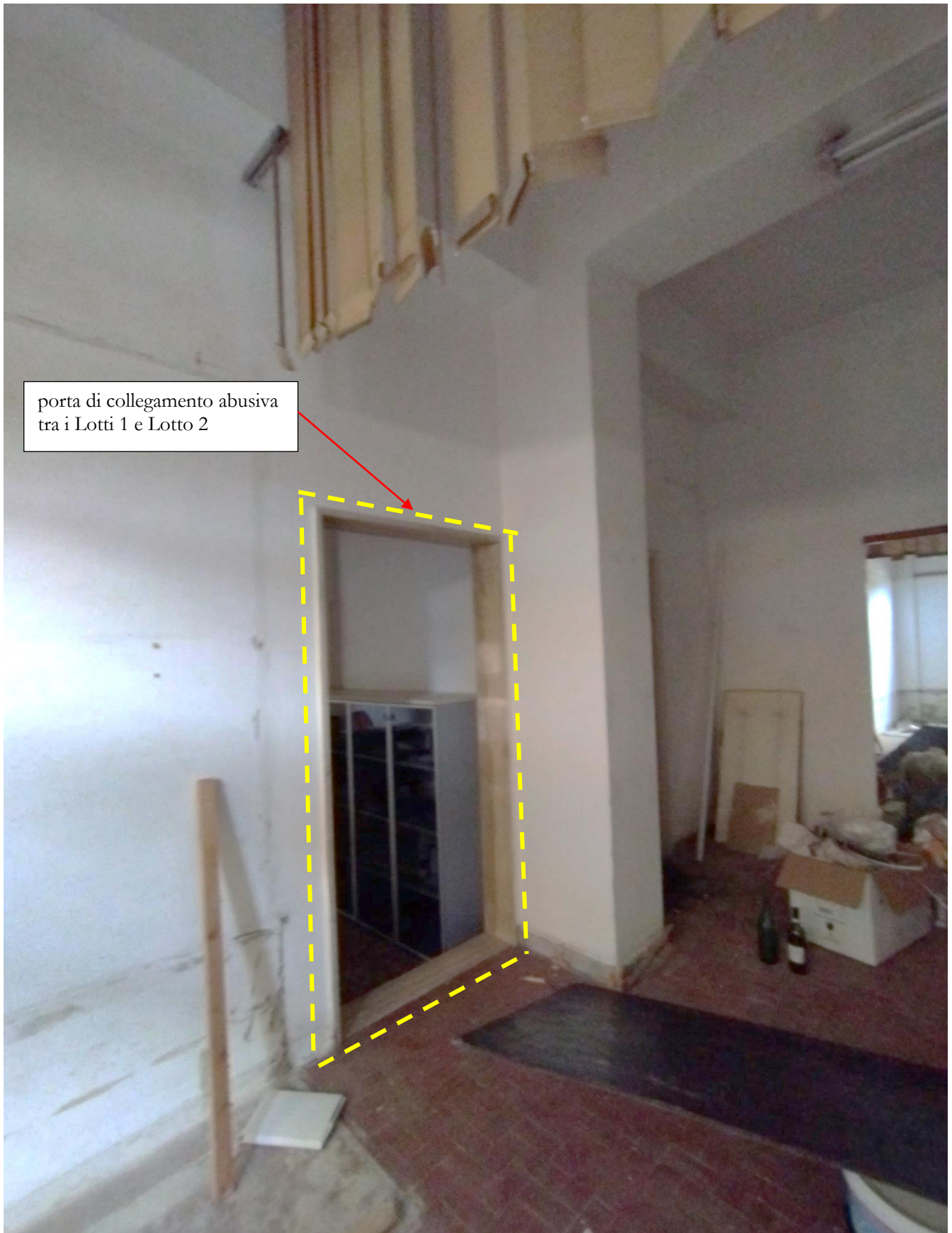
Fig. Vista porta di collegamento abusiva tra i Lotti 1 e Lotto 2
