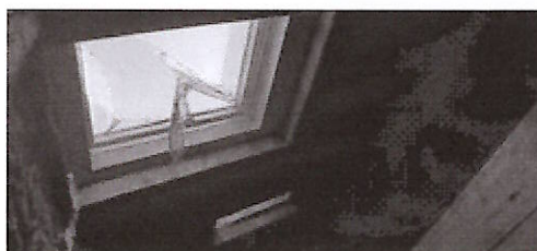
Vista della finestra a tetto distrutta
