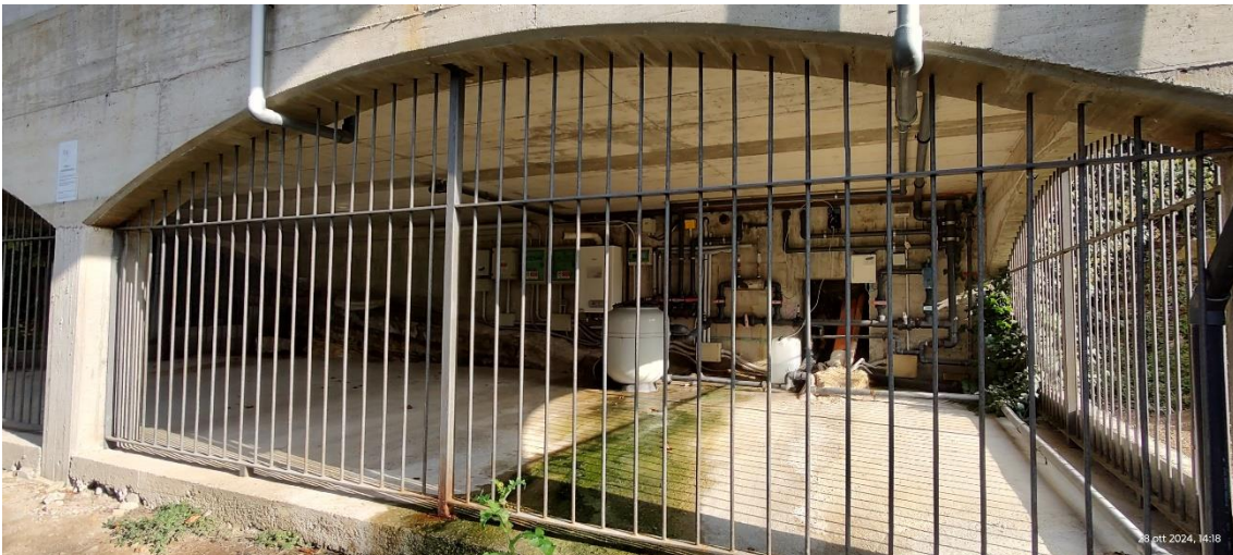
Sotto veduta della zona tecnica ricavata sotto la piscina
