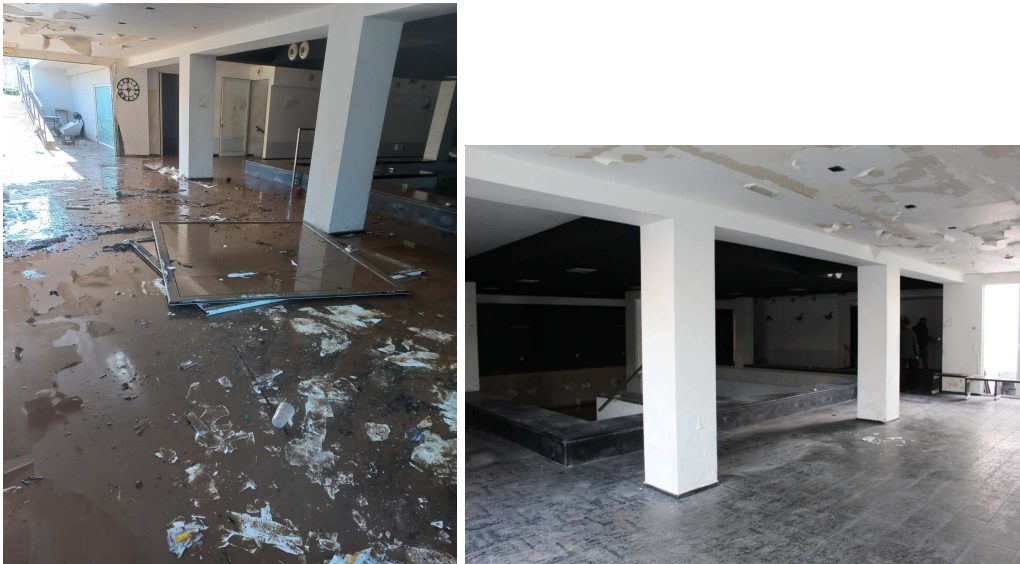
La foto a sin, fornita da [redacted] mostra la situazione della pavimentazione al termine dello svuotamento. La foto a dex la situazione al momento del mio sopralluogo.
