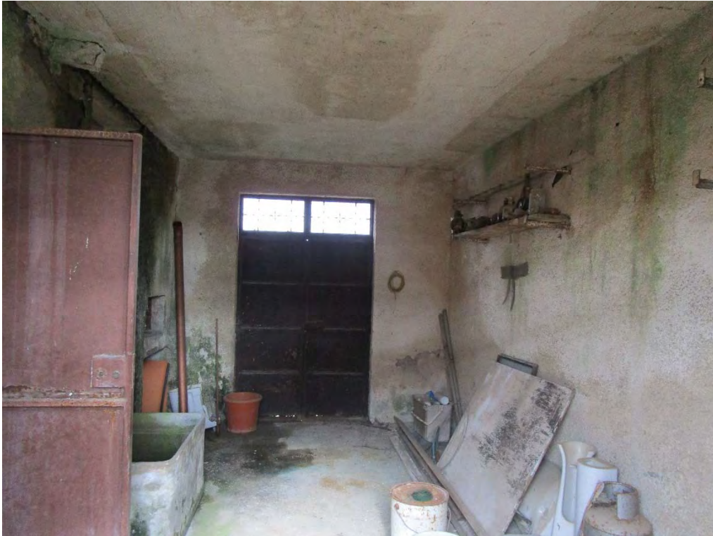
Foto 7 – Vista interna unità collabente
