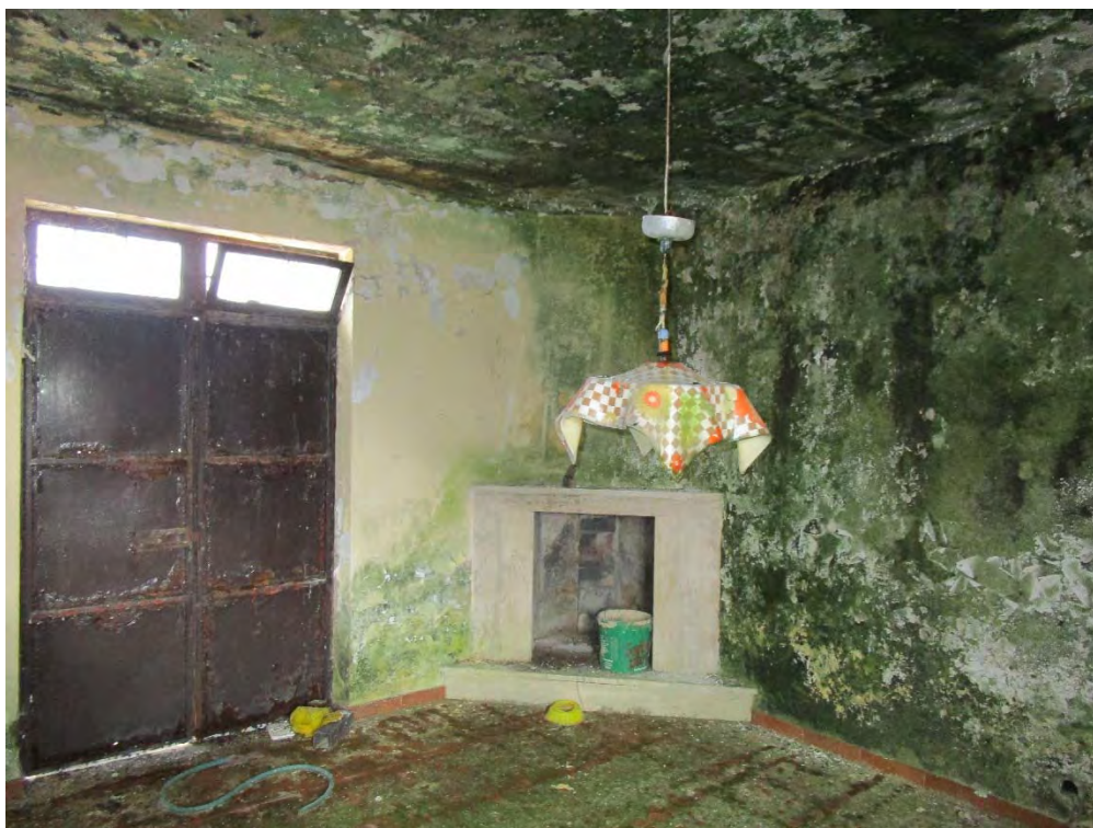
Foto 13 – Vista interna unità collabente
