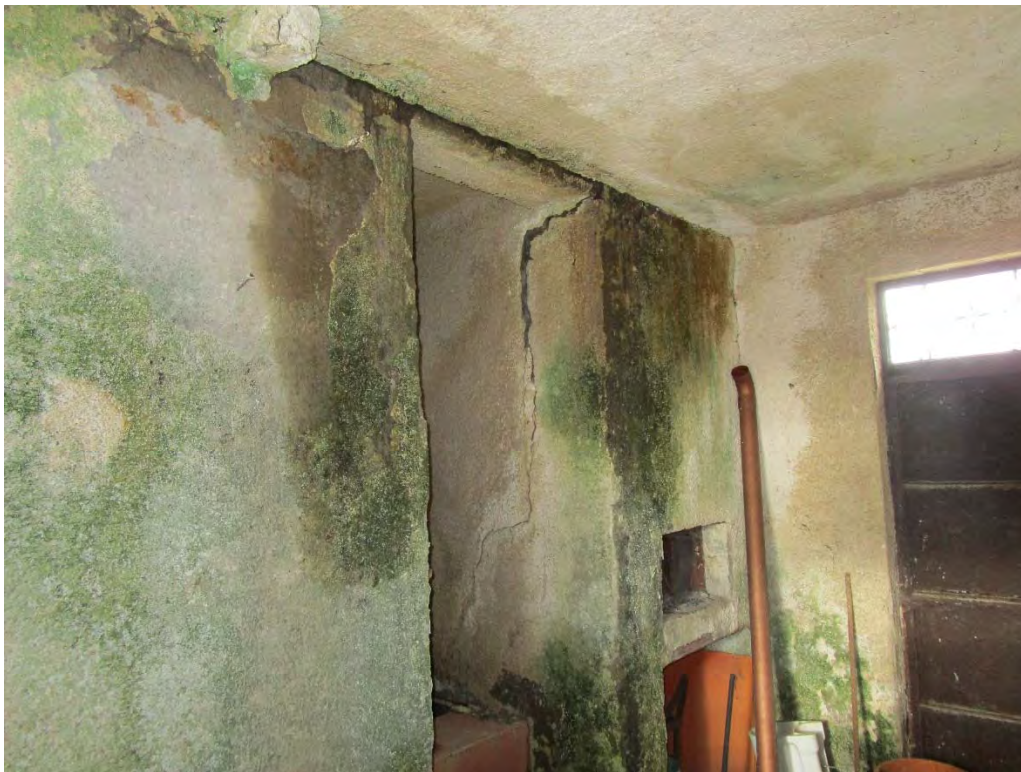
Foto 8 – Vista interna unità collabente
