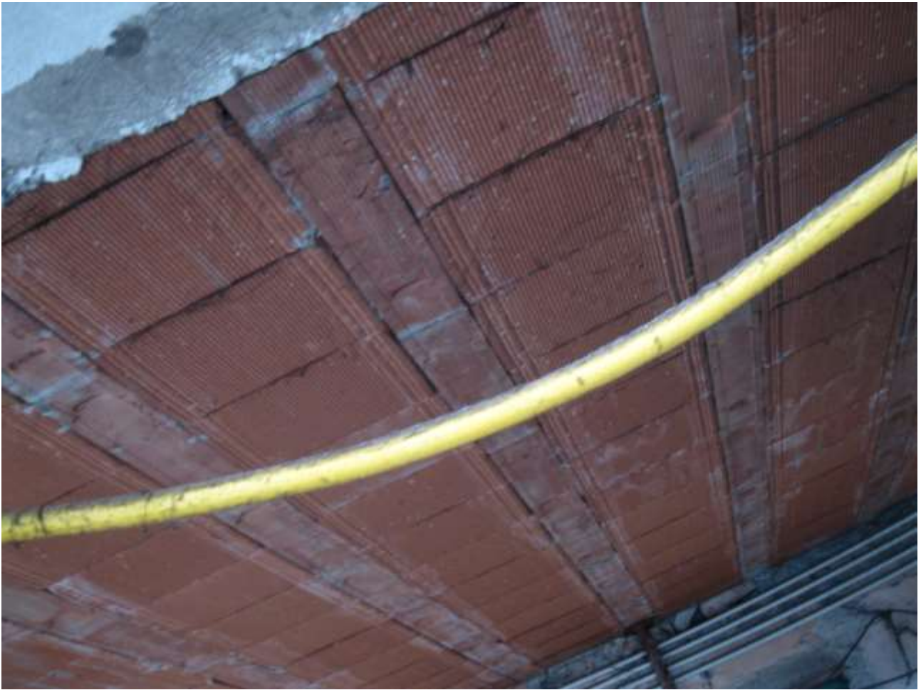
FOTO 8: particolare del solaio che sorregge il primo piano di nuova fattura (abusiva in sostituzione di quello originale in legno) e visto dal cortile
