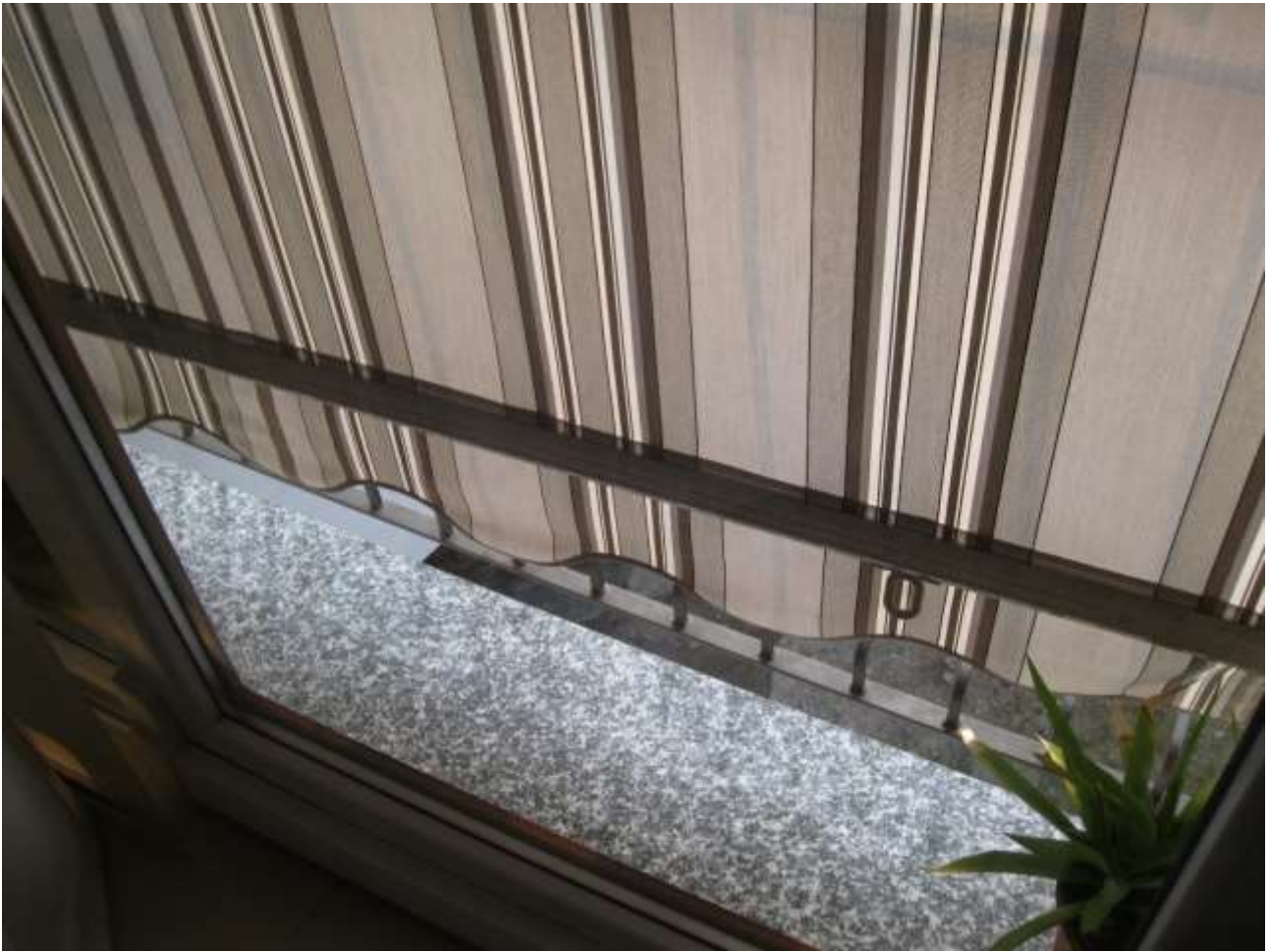
FOTO 24: particolare di serramenti, soglie di serizzo e ringhiere realizzate abusivamente sulla facciata verso il cortile
