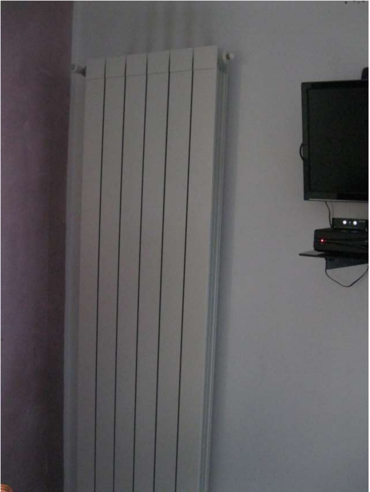
FOTO 19: particolare dei termosifoni nell'appartamento al primo piano
