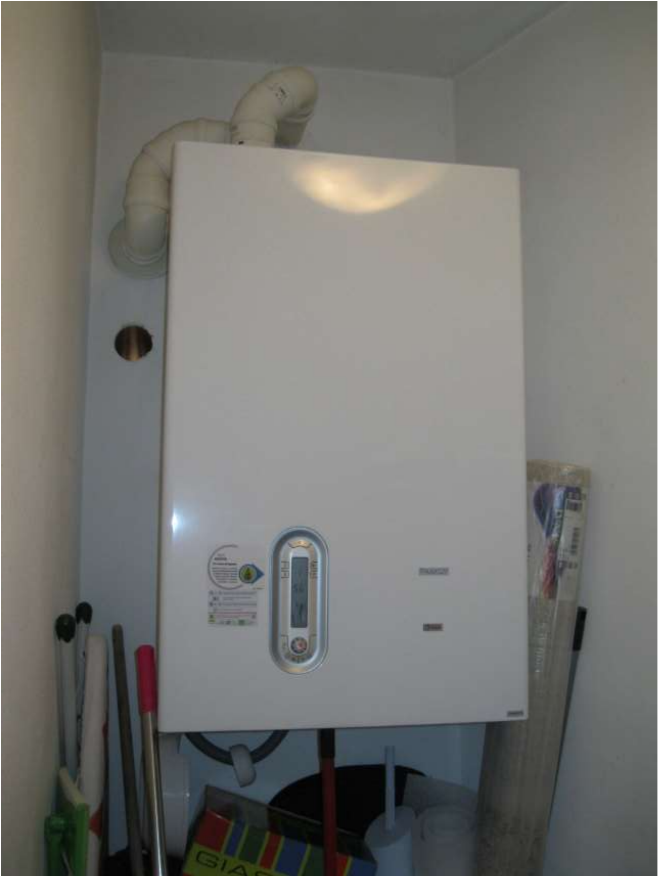
FOTO 21: particolare della caldaia murale per l'appartamento al primo piano situata nell'ex wc nell'ex loggiato originariamente aperto
