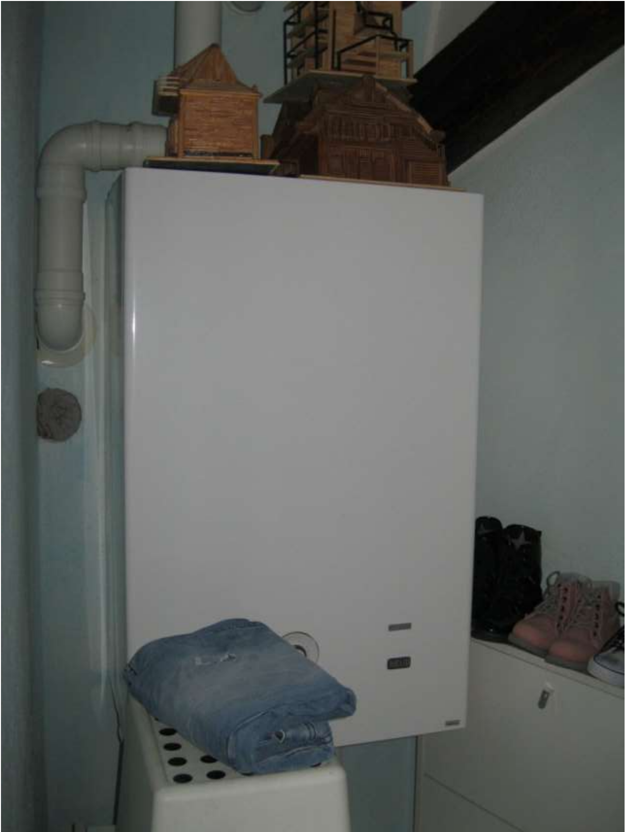
FOTO 28: particolare della caldaia murale di riscaldamento per l'appartamento nel sottotetto.
