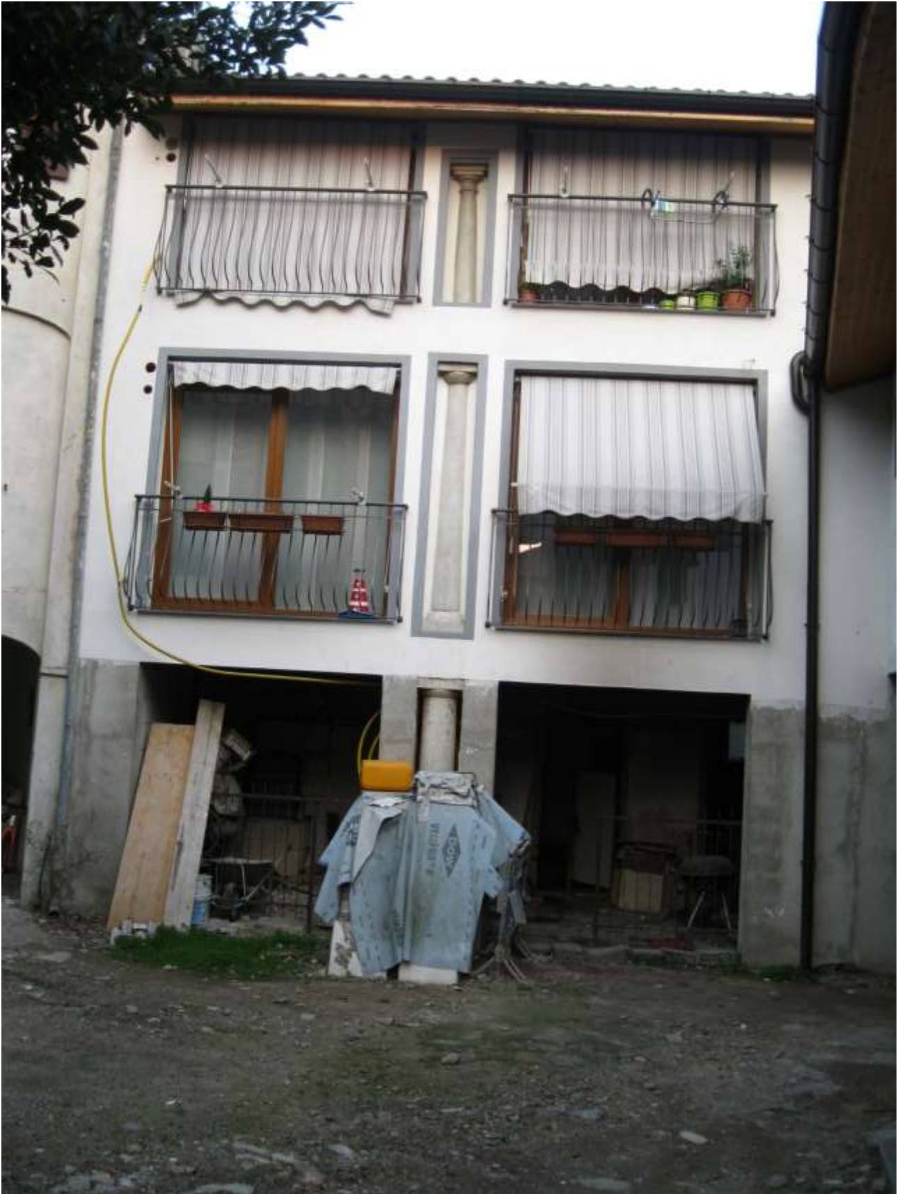
FOTO 5: la facciata della casa verso il cortile con i porticati chiusi abusivamente con muri, serramenti e ringhiere
