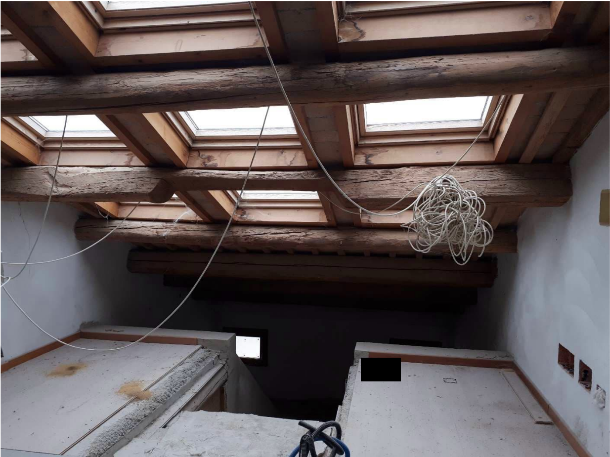
Zona accesso ultimo appartamento che deve essere sanata (previsto spesa demolizione per ripristino)
