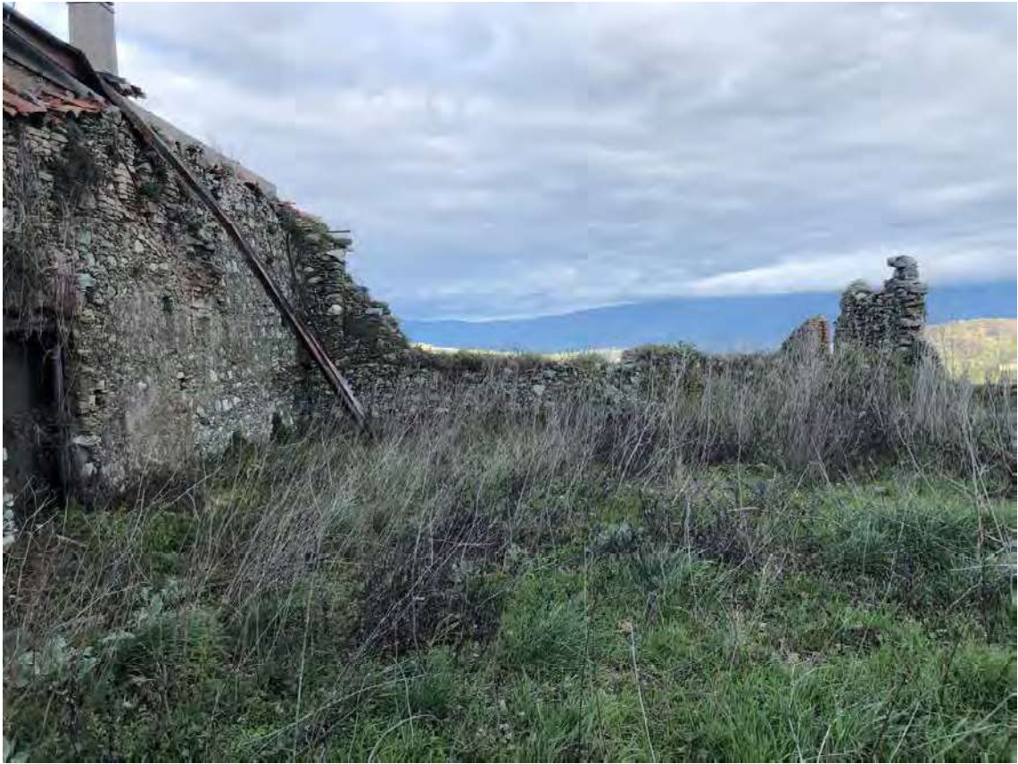
Foto 137 - San Benedetto Ullano (CS). Fabbricato diruto fg.7, p.lla 35-36
