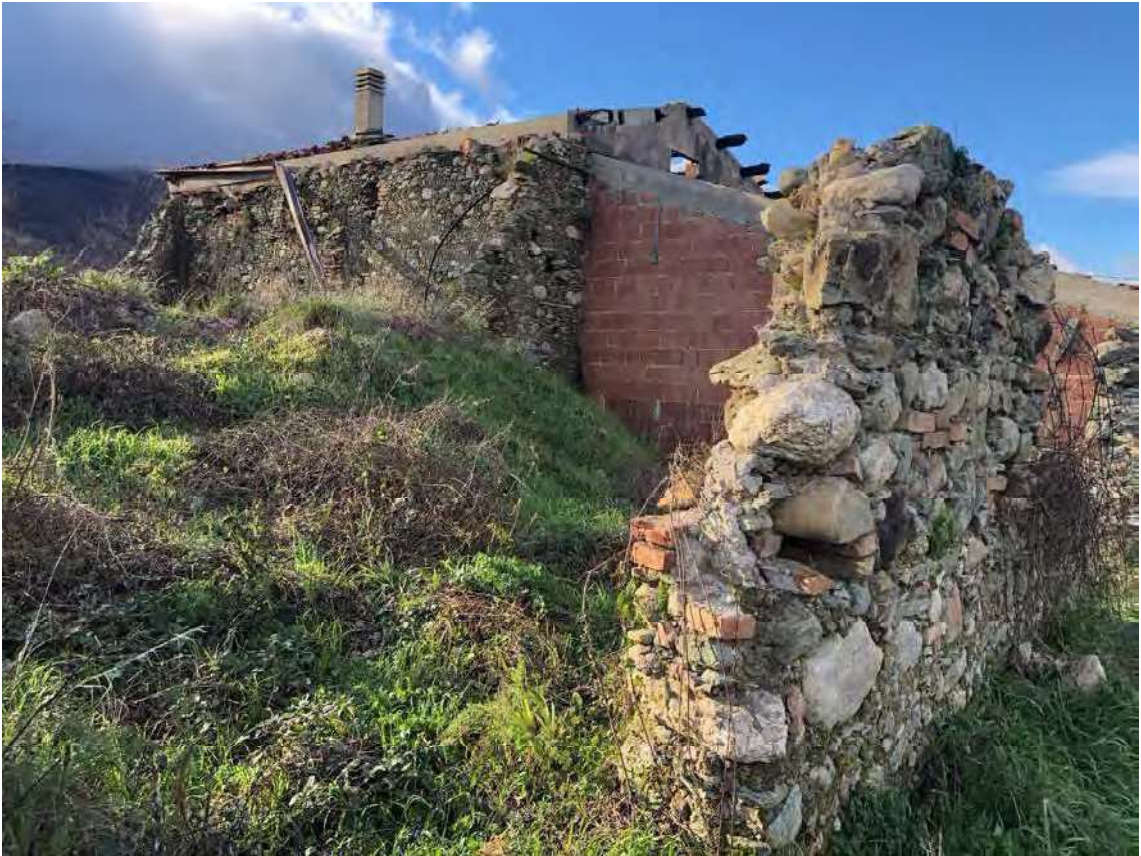
Foto 138 - San Benedetto Ullano (CS). Fabbricato diruto fg.7, p.lla 35-36
