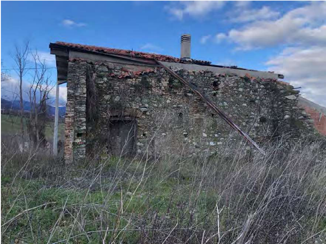
Foto 136 - San Benedetto Ullano (CS). Fabbricato diruto fg.7, p.lla 35-36
