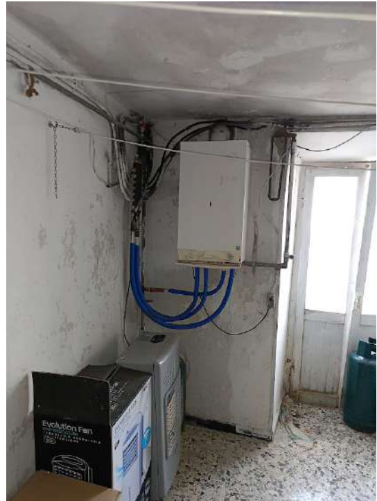
Part. Caldaia e collettore 1° livello sotto-strada
