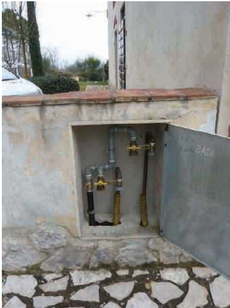
controporta esterna in legno - vano contatori gas
