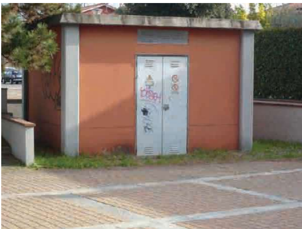
cabina elettrica - accesso
