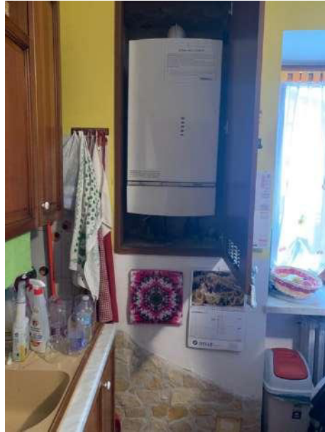
Particolare caldaia murale in nicchia
