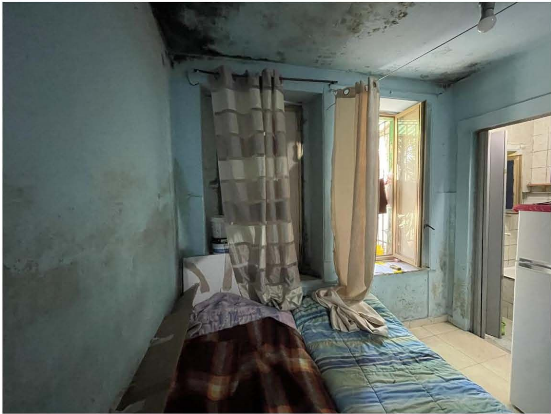
Canera da letto 2. Si evidenziano infiltrazioni e muffe sulle superfici murarie.
