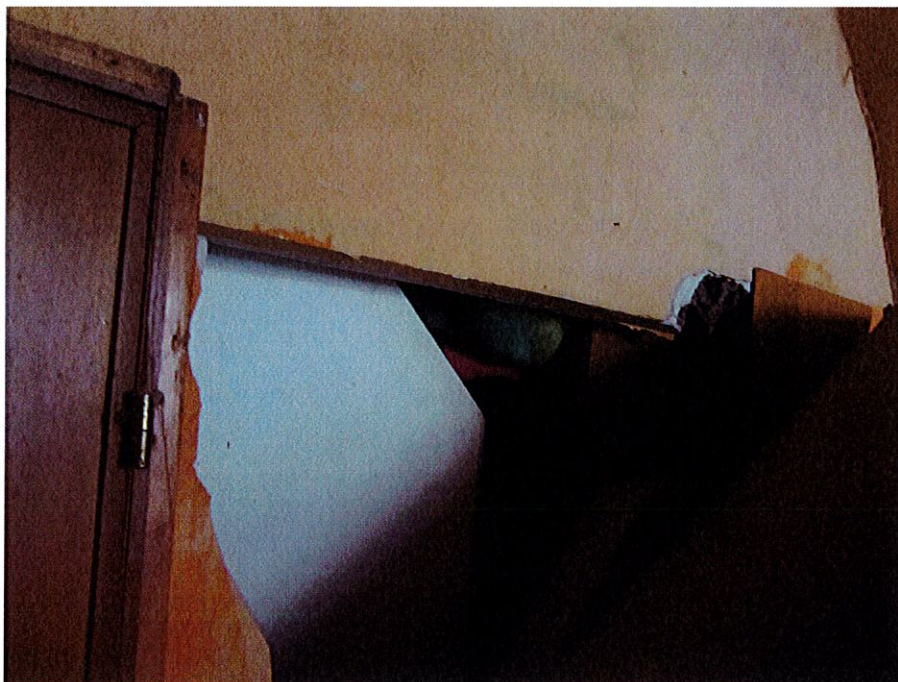
3 – particolare dello spigolo superiore del passaggio che è stato tompagnato con un pannello di compensato da mm. 4; la bussola che si intravede sulla sinistra è quella del varco modificato del bagno.
