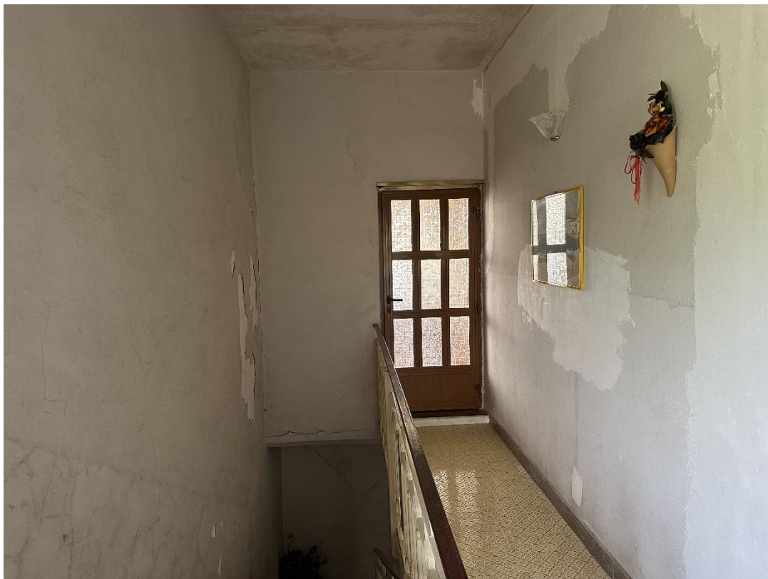
FOTO: PARTICOLARE DELLE DISTACCO DELL'INTONACO SULLE PARETI DEL VANO SCALE
