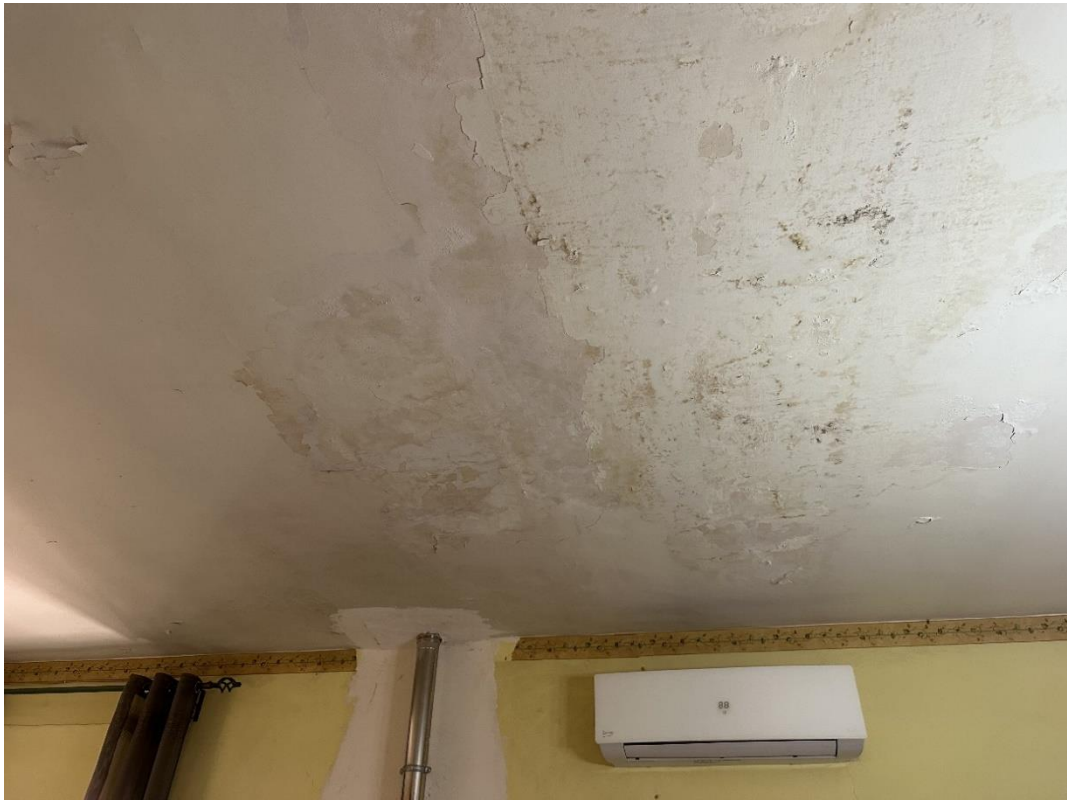
FOTO: PARTICOLARE DELLE MACCHIE DI MUFFA VERDE SUL SOFFITTO DEL VANO SOGGIORN N°1
