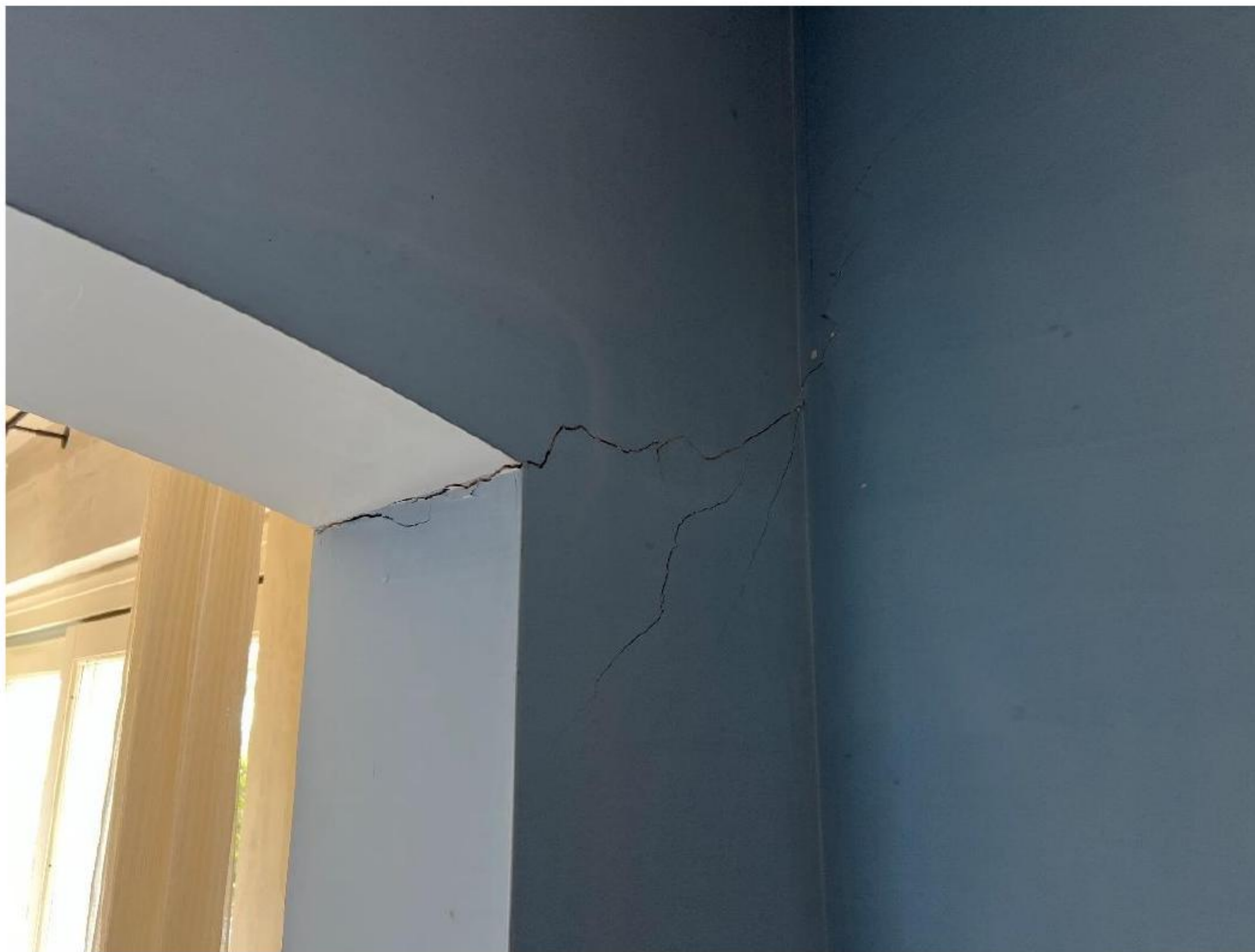
Lesioni da cedimento fondale parete zona ingresso piano terra
