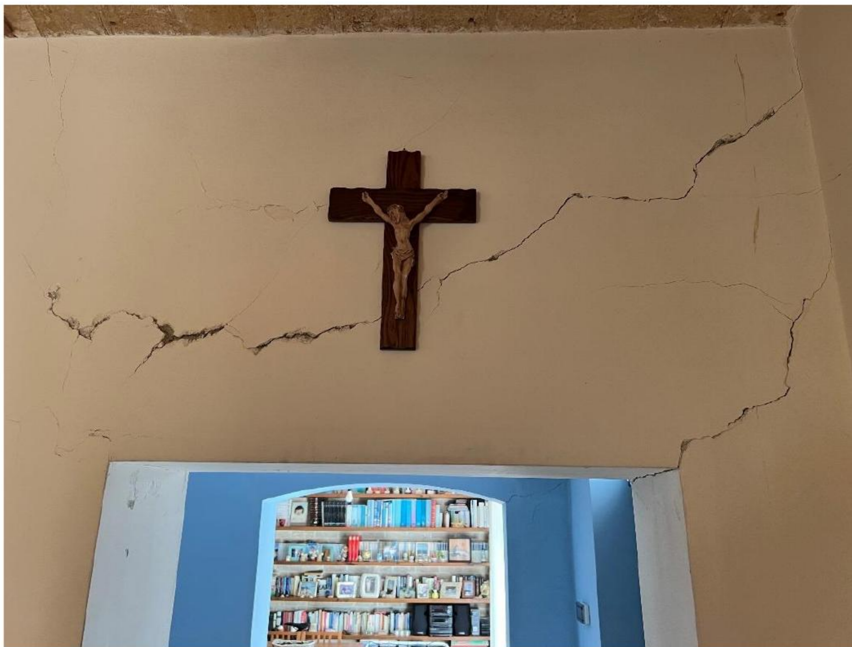
Lesioni da cedimento fondale locale parete cucina piano terra
