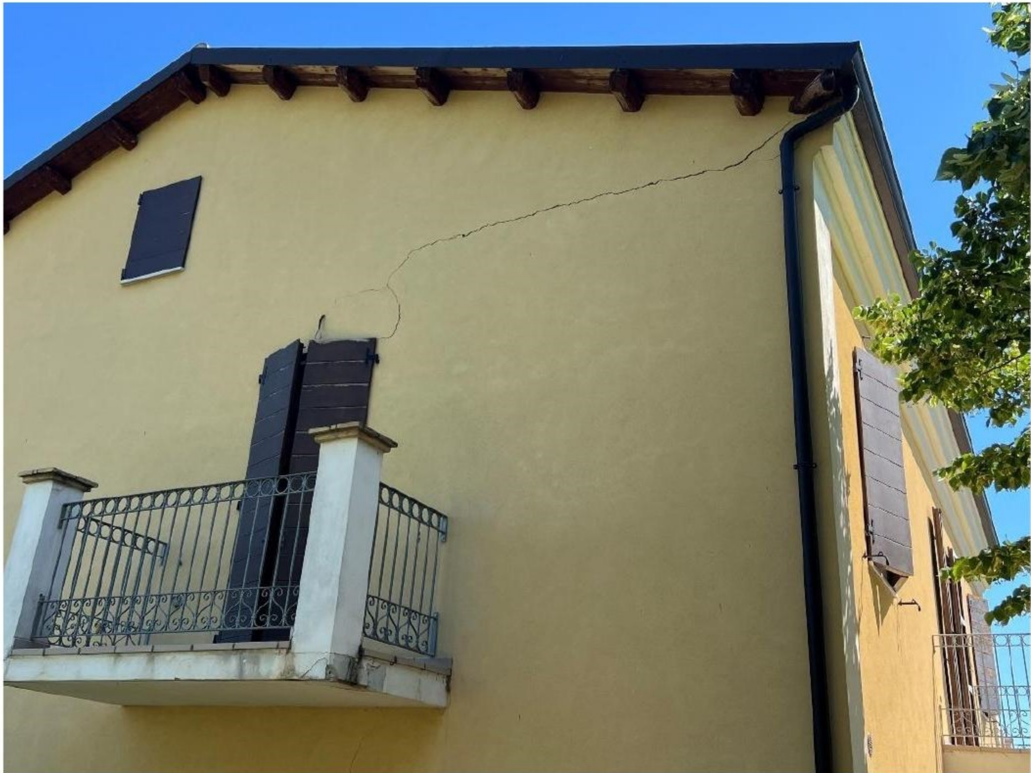
Lesioni da cedimento fondale parete esterna lato ovest piano primo
