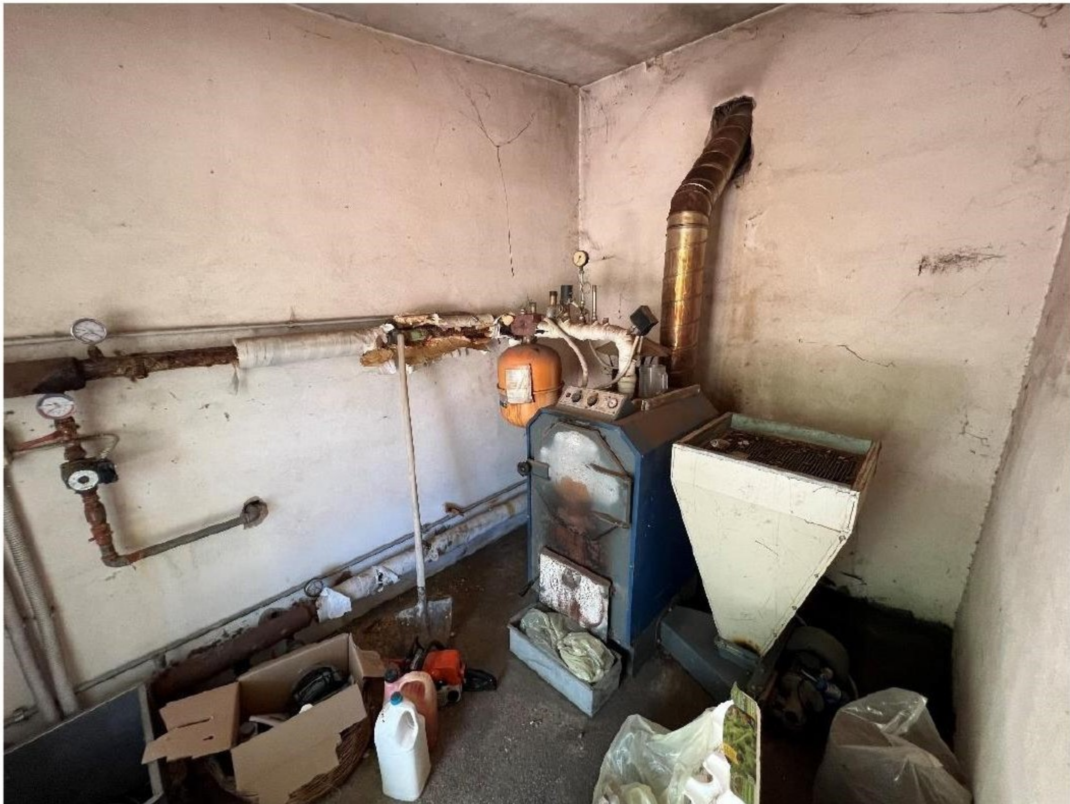
Locale centrale termica
