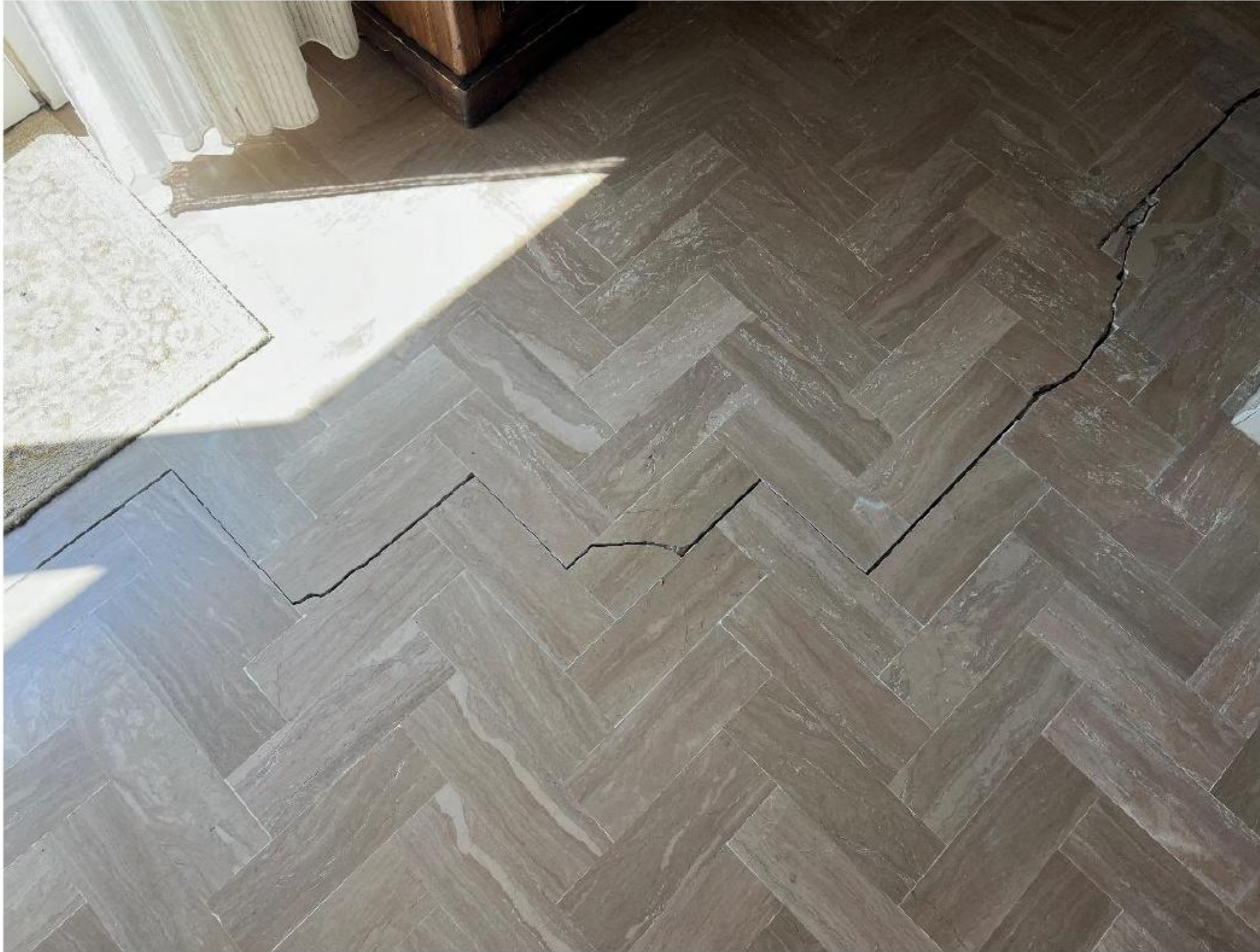
Lesioni da cedimento fondale pavimento locale soggiorno piano terra
