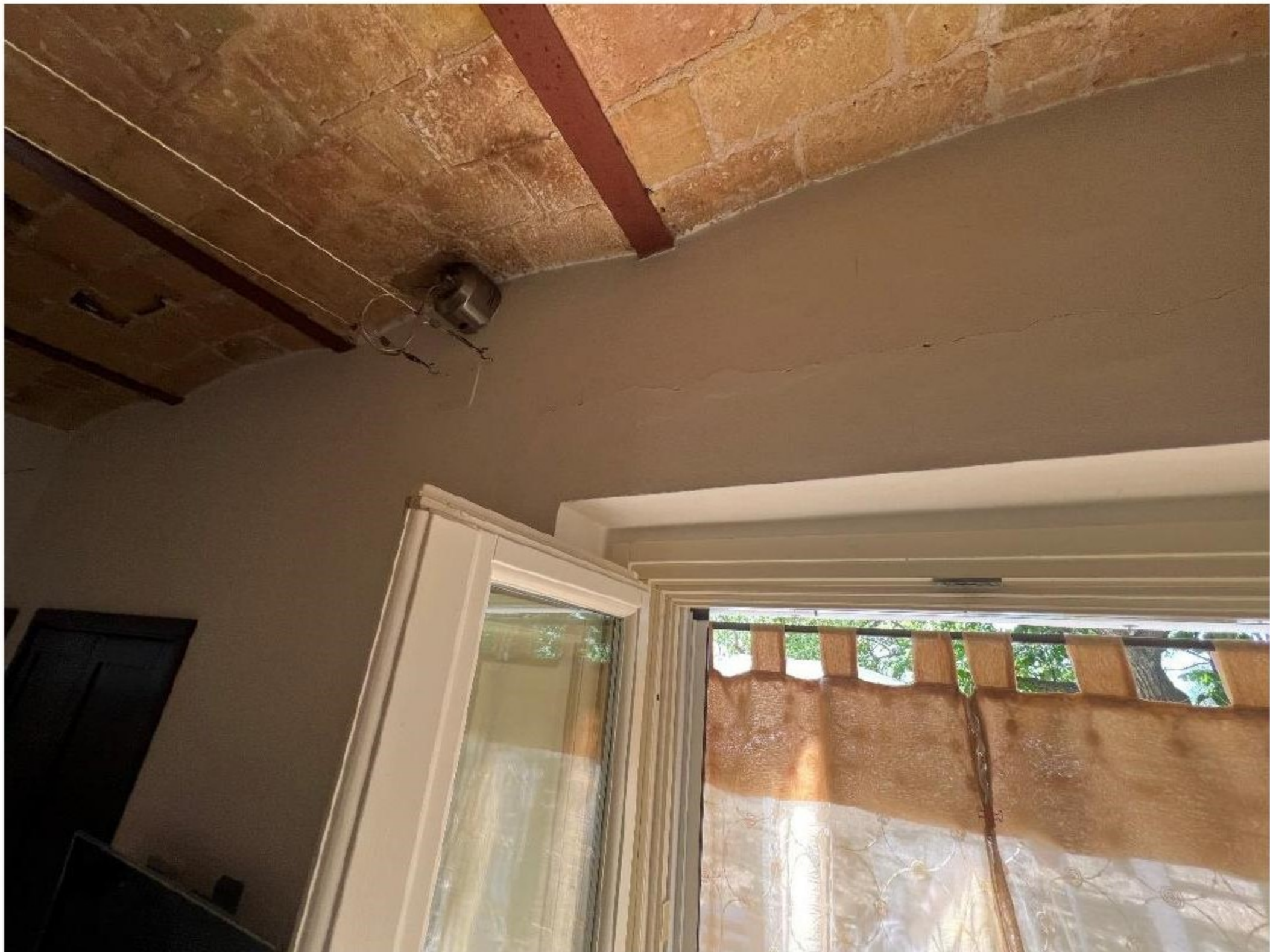
Lesioni architrave finestra locale cucina piano terra
