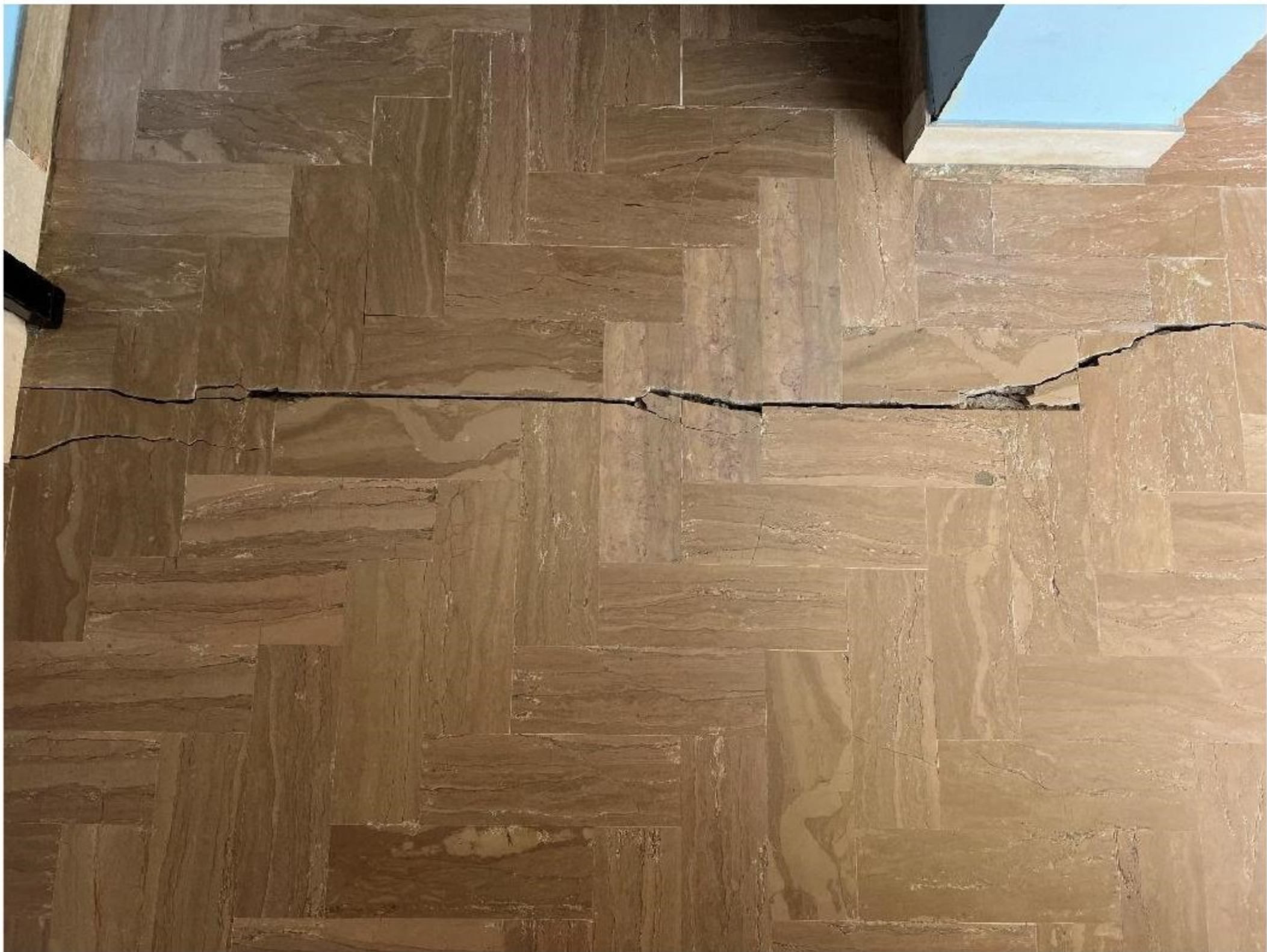
Lesioni da cedimento fondale pavimento zona ingresso piano terra
