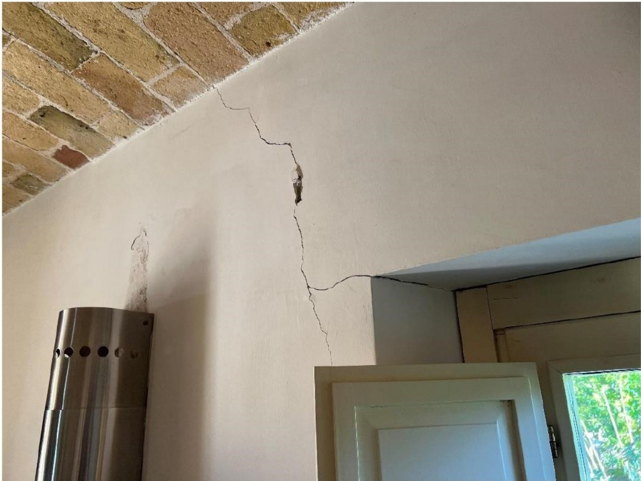
Lesioni da cedimento fondale parete locale cucina piano terra
