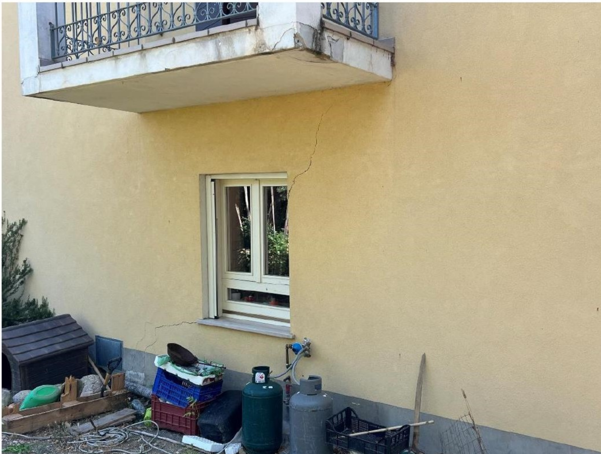
Lesioni da cedimento fondale parete esterna lato ovest locale cucina piano terra
